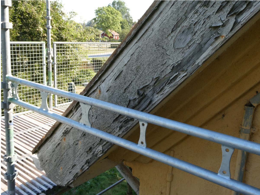
Före åtgärder. Alla vindskivor förutom den nordöstra är äldre breda och i ett stycke.
