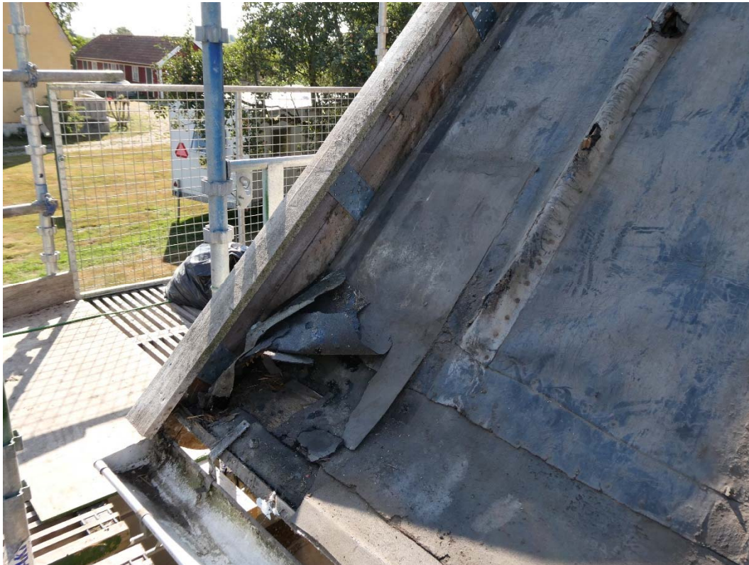
Östra gavelns vindskiva var sedan tidigare i nedre halvan ersatt med två brädor i höjd och spikband som håller ihop brädorna. Här fanns också rötskador i undertaket.
