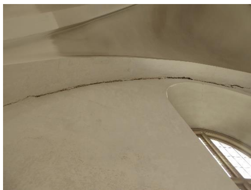
Blekgula färgspår i sprickan mellan vägg och valv.
