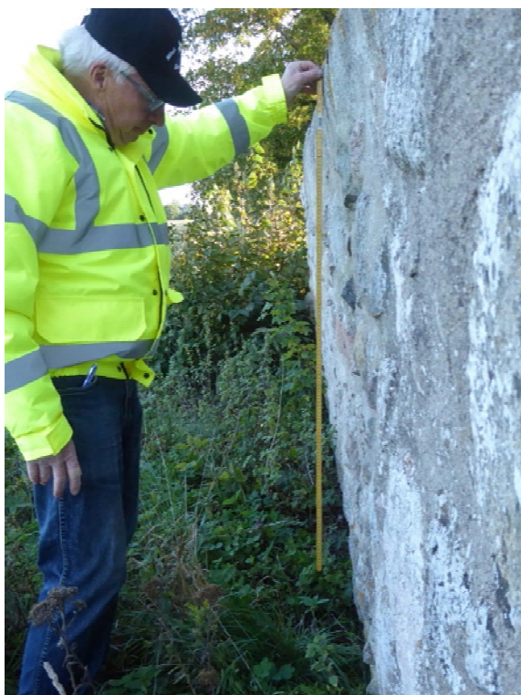
Före åtgärder. Den del av muren som stod upp intill rasade delen visar at muren lutade utåt.
