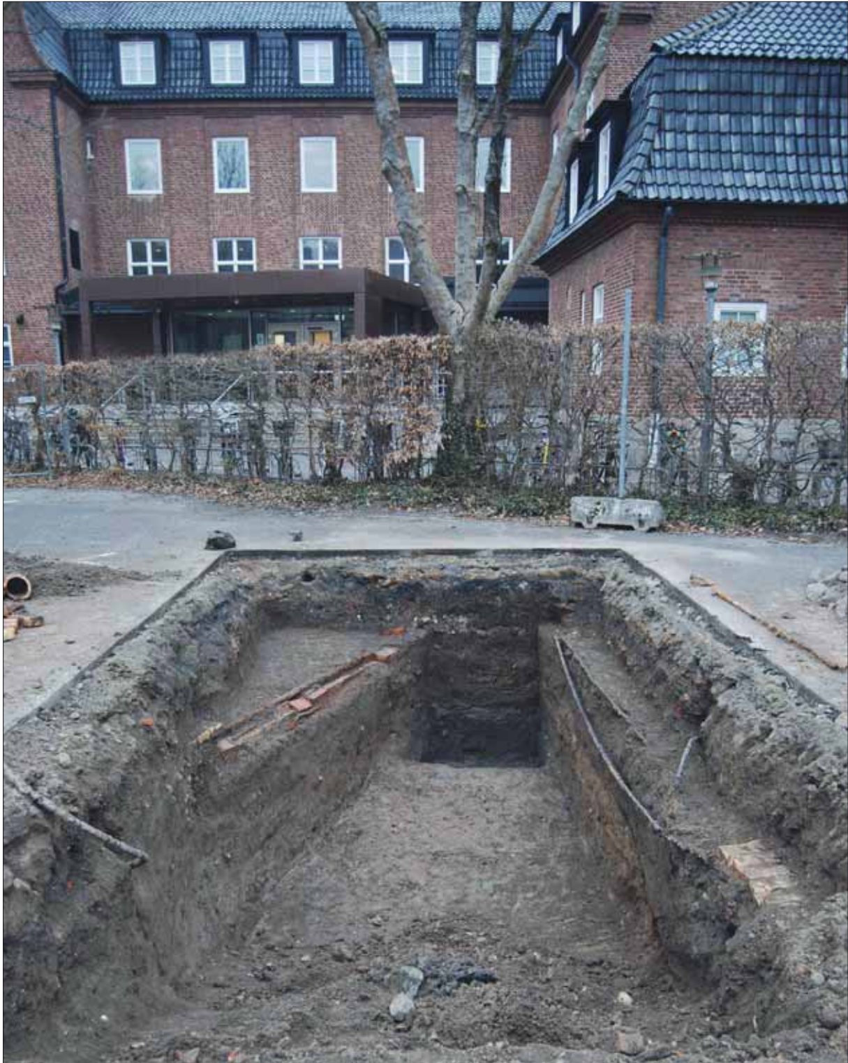
Figur 54. Kabel- och rördragningar i schakt 2. Längst bort skymtar nedgrävningen för ett dike (K1177) från period 4. Damm i förfall. I bakgrunden skymtar gamla centralköket. Fotografiet taget från öster.
