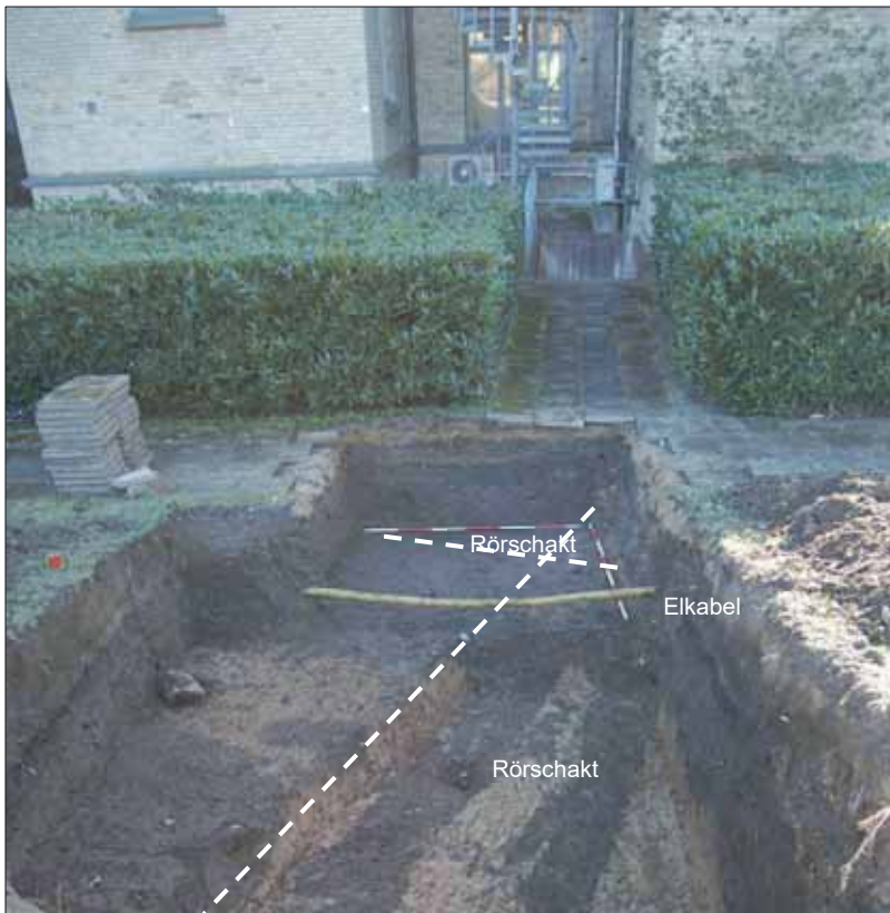
Figur 56. I schakt 4 fanns det flera rör- och kabeldragningar som var okända och som betydligt minskade möjlig yta att handgräva. Fotografiet taget från norr.
