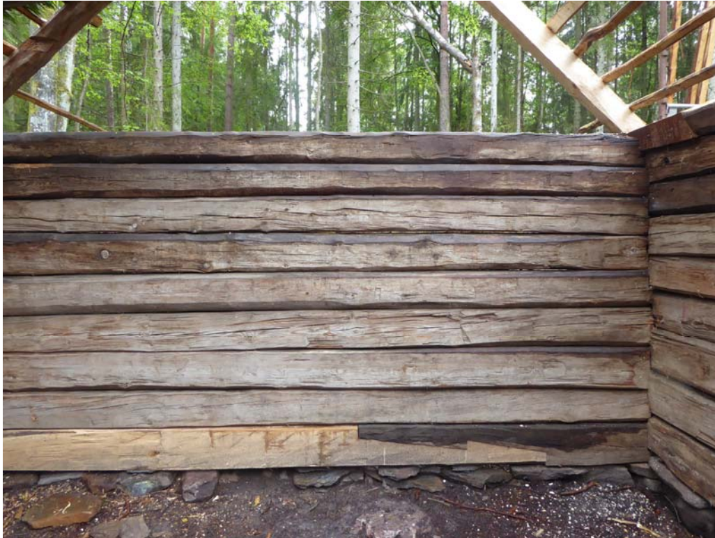
Blixtskarv i det nedre fotvarvet. Östra fasaden.
