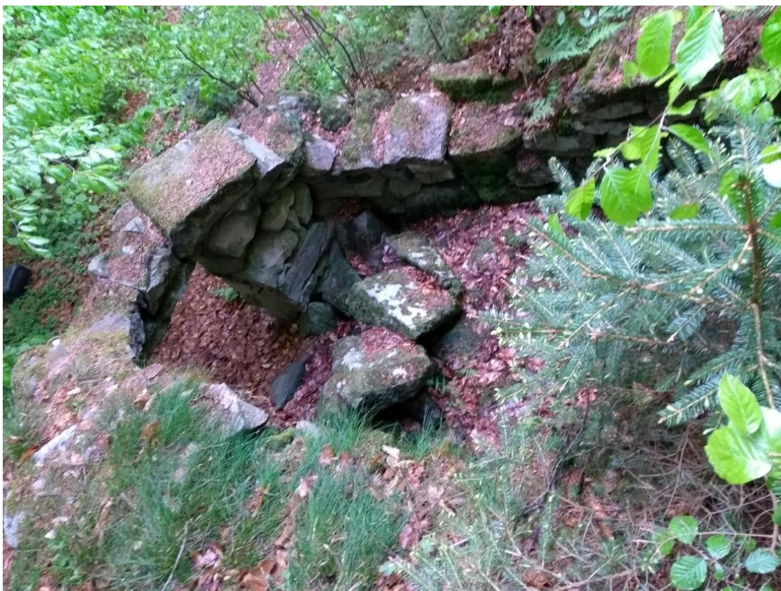
Figur 16. Eldarehuset från ovansidan visar det inrasade taket.
