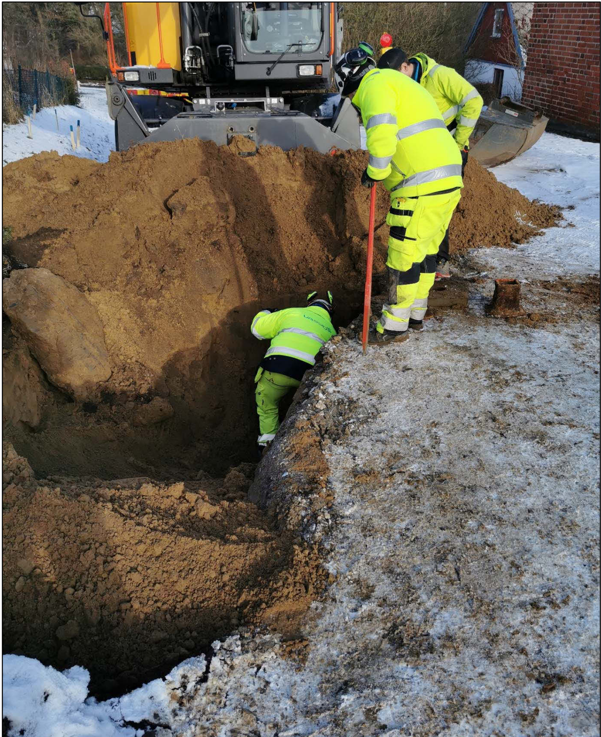
Figur 8. Servisens läge var felaktigt utsatt på kartan, schaktet blev större och djupare än planerat. Foto från söder.
