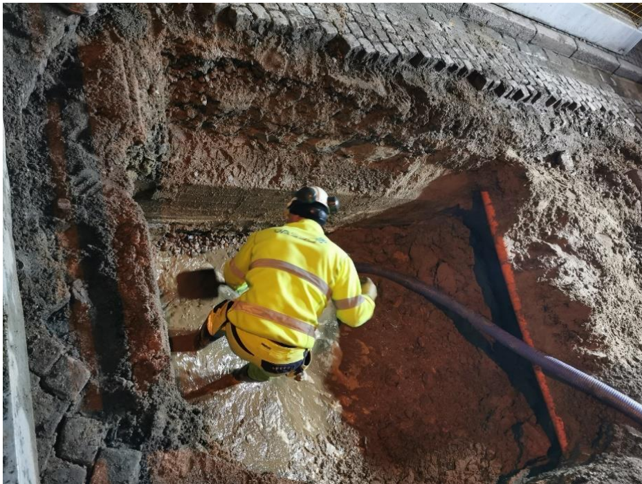
Figur 5. Översikt över schaktet och vattenläckan i Grönegatan. Fotografiet taget från nordväst.
