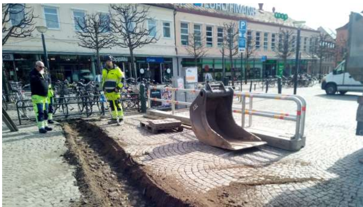
Figur 7. Den äldre stenläggningen framschaktad i den östligaste delen av schakt 4. Foto från väst/nordväst.
