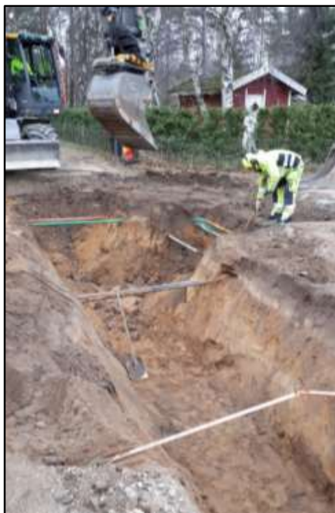
Figur 5. Schakt 6, Södergårdsvägen. Ett flertal el-, tele- och fiberledningar ses i bild, vilka försvårade arbetet i fält och vilka hade orsakat i att fornlämningen bitvis var förstörd.
