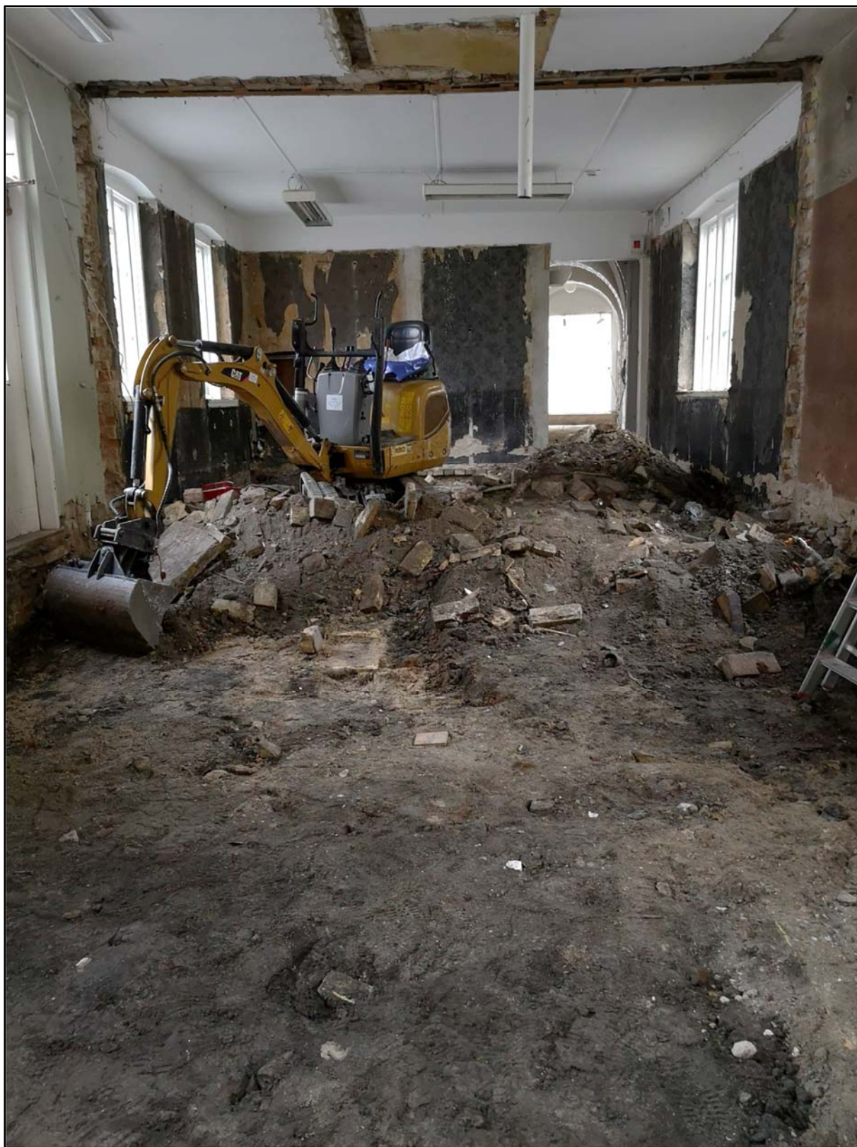
Figur 5. Status då schaktningsarbetena upptäcktes. Under golv och bärlager fanns intakta kulturlager kvar med datering 16–1700-tal. Fotografiet taget från väster.
