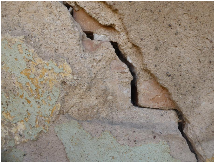
Före åtgärder. Sprickan sedd från utsidan med puts- och färglager. April 2019
