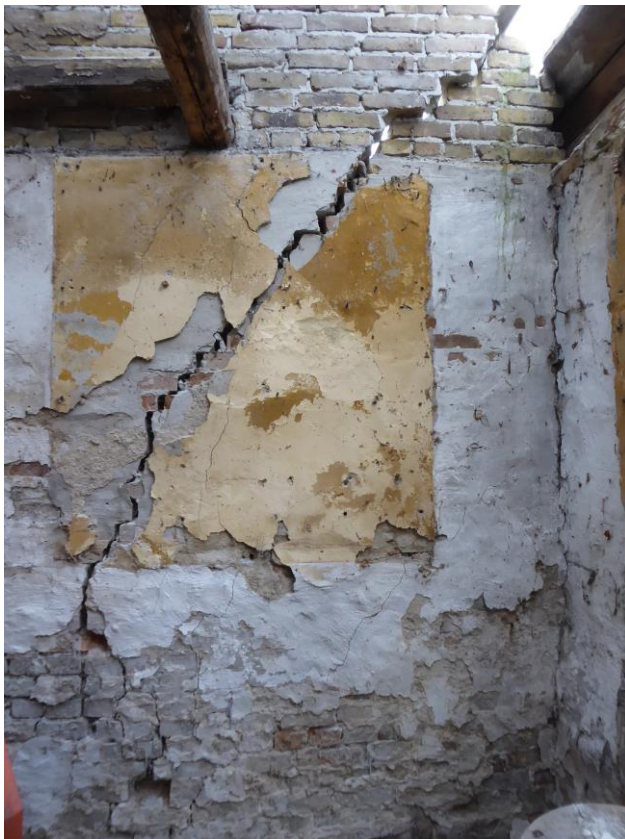
Före åtgärder. Sprickan sedd från insidan med puts- och färglager. April 2019
