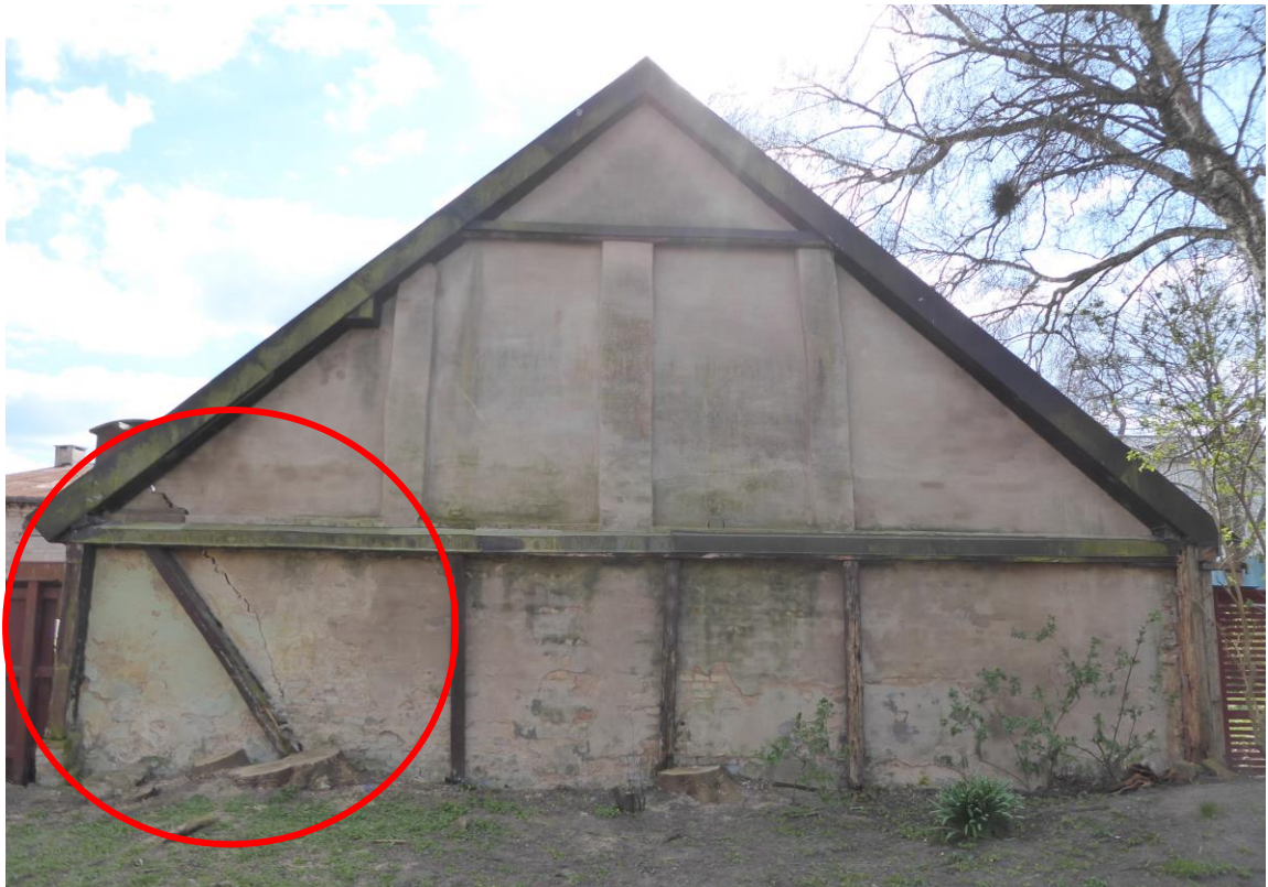
Före åtgärder. Sprickan vid östra hörnet på norra fasaden. April 2019.
