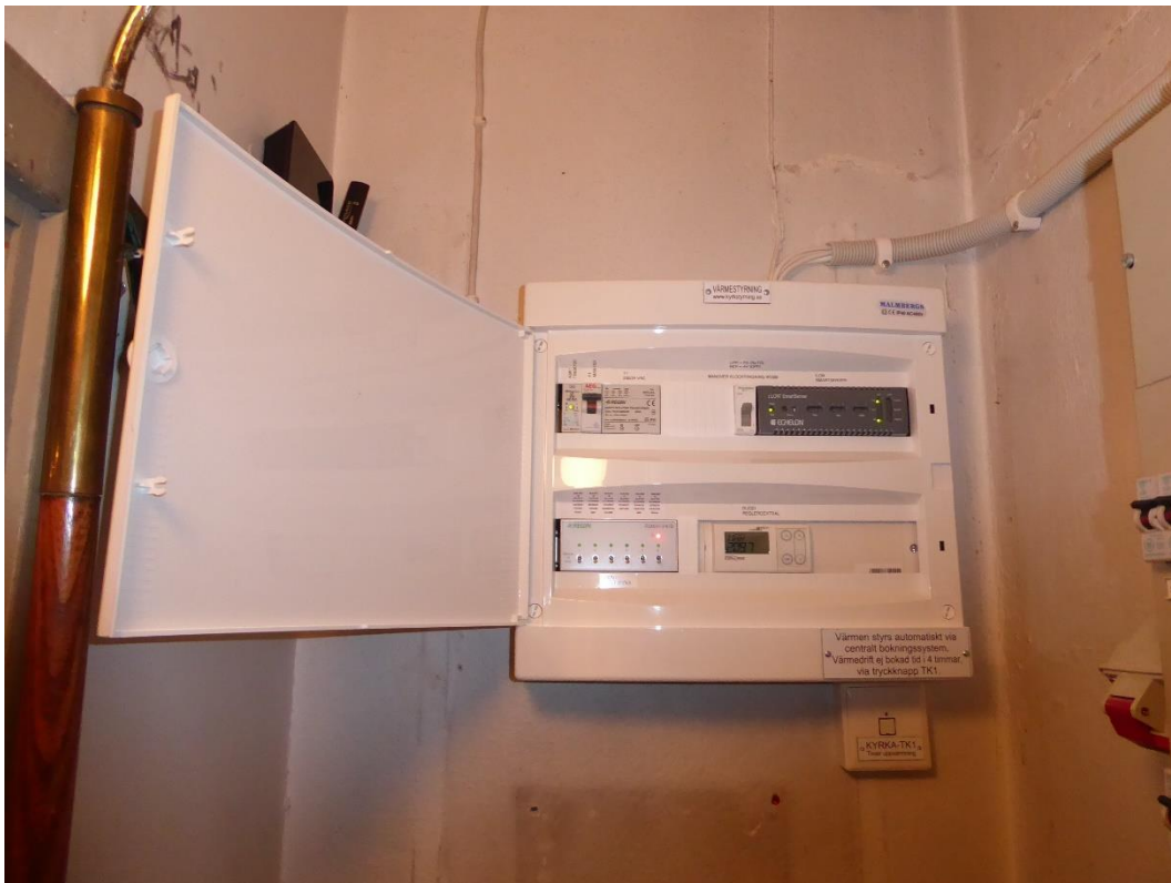
El-central före åtgärder samt tillkommen installation i el centralen.
