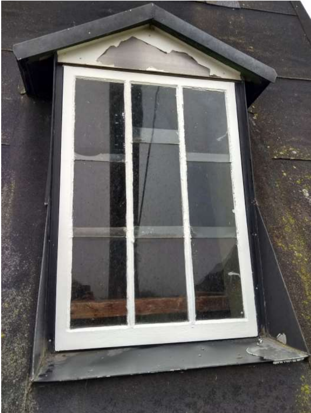
Fönster I på bottenplan med visst "ojämnt" kitt kvarlämnat.
