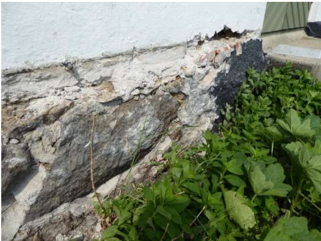
Längst till höger vid dörren hade några lerstenar luckrats upp innanför putsen. Detta kan vara en följd av hög fuktbelastning ifrån grunden.
