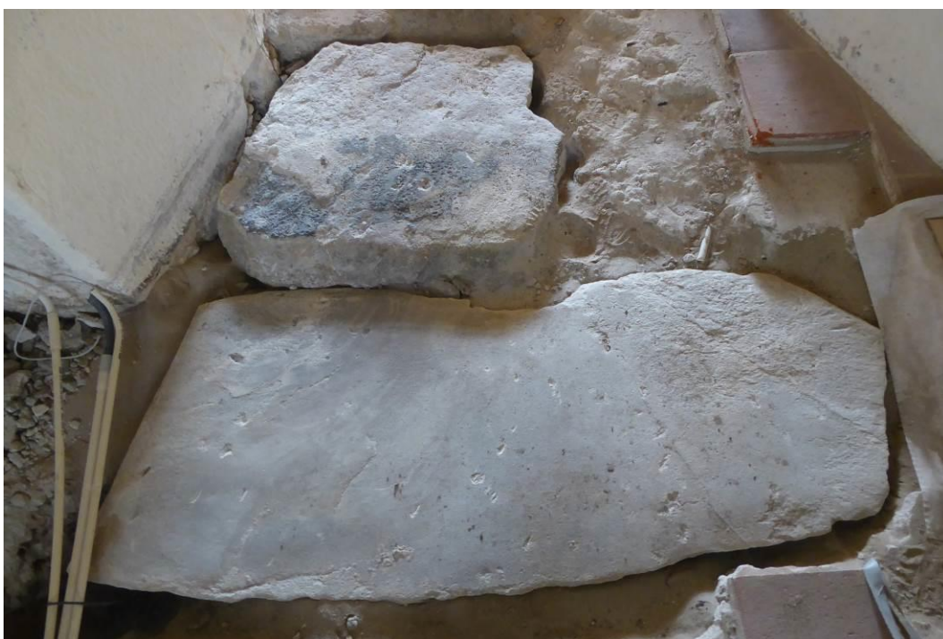
Stenar under betongplattan invid dörren mellan långhus och vapenhus blottades under arbetet.
