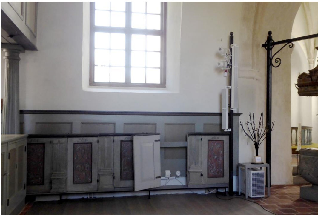
Nykyrkan, konvektorer och installationer bakom skärmar byggda av demonterade bänkgavlar/dörrar.
