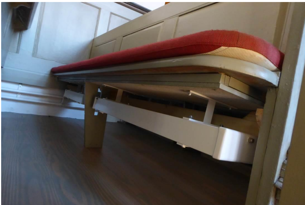
Bänkvärmare monterade med distans, isolering och skiva som skyddar bänkarna från uttorkning. Nytt brädgolv under bänkraderna.
