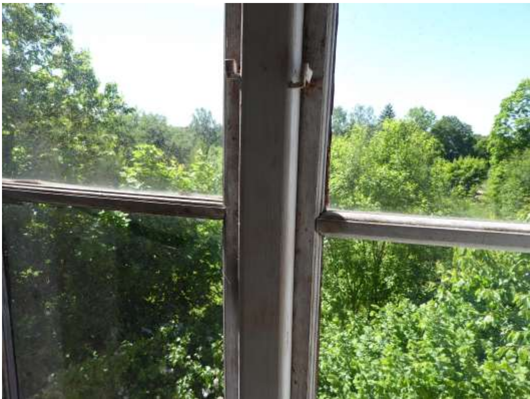
Stängningsbeslag av smidda varpor. Högra spröjsen utbytt med en avvikande profil.
