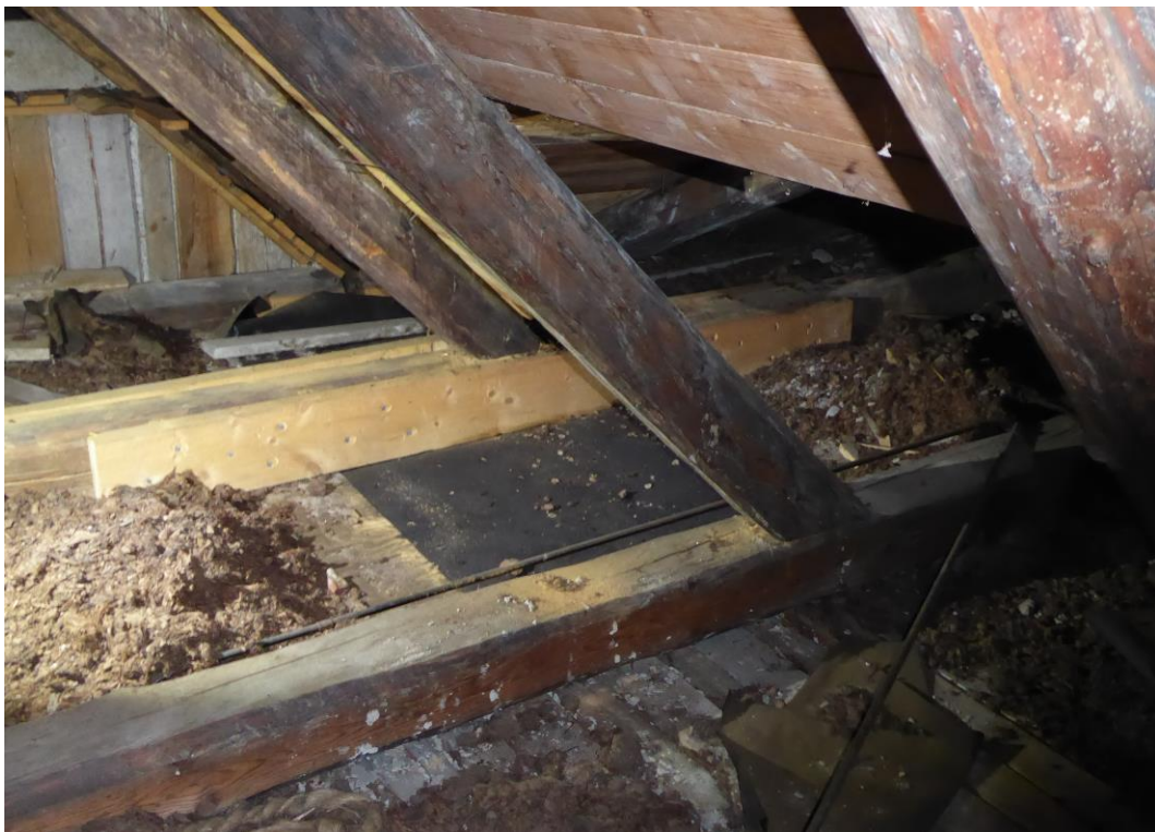
24. Vinden. Bilden tagen där frontspisen ansluter. Trossbottenfyllningen borttagen där innertaket lagats, troligtvis efter läckage ifrån taket.
