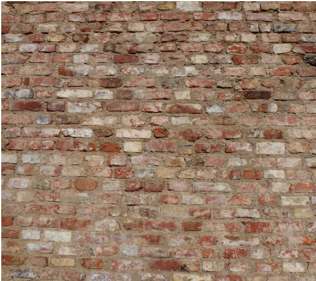
8 Östra fasaden 2013 då putsen knackats ned.
