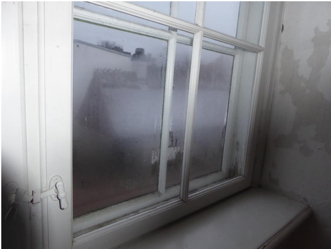
23. Fönster i kupan i rum 208 med överfalsade innerbågar. Tätningslist saknas vilket orsakar kondens.
