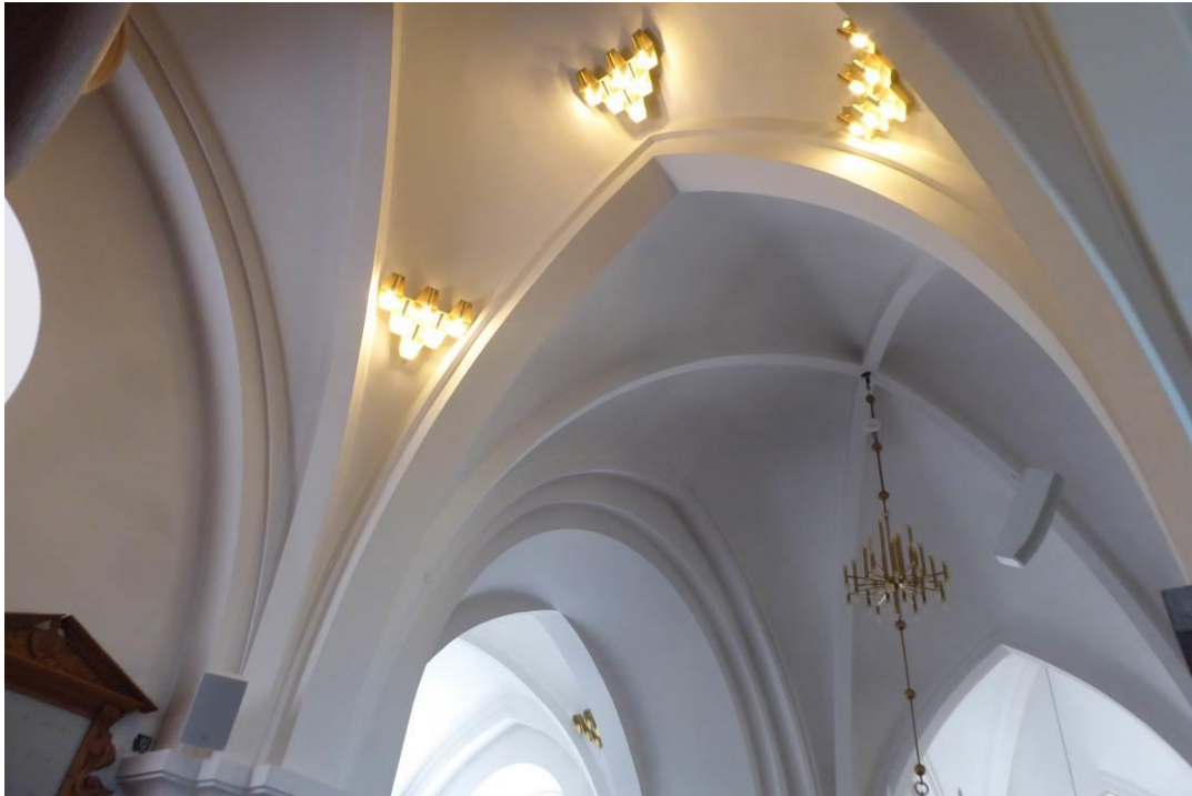
Efter åtgärder, norra korsarmen vy mot sydost. Nya LED-lampor i lampetterna, en ny högtalare på pilastern till vänster i bild. I korsarmsmitten hänger den nya högtalaren i en vajer.
