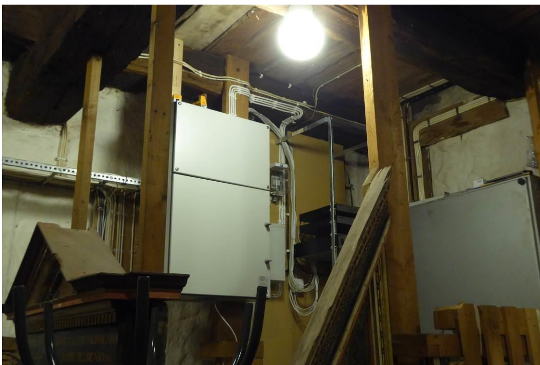
Efter åtgärder. Ny elcentral i tornet på samma plats som den tidigare.
