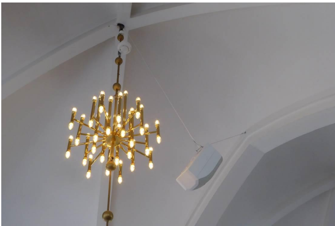
Efter åtgärder. En ny högtalare i vajer i korsarmens mitt.
