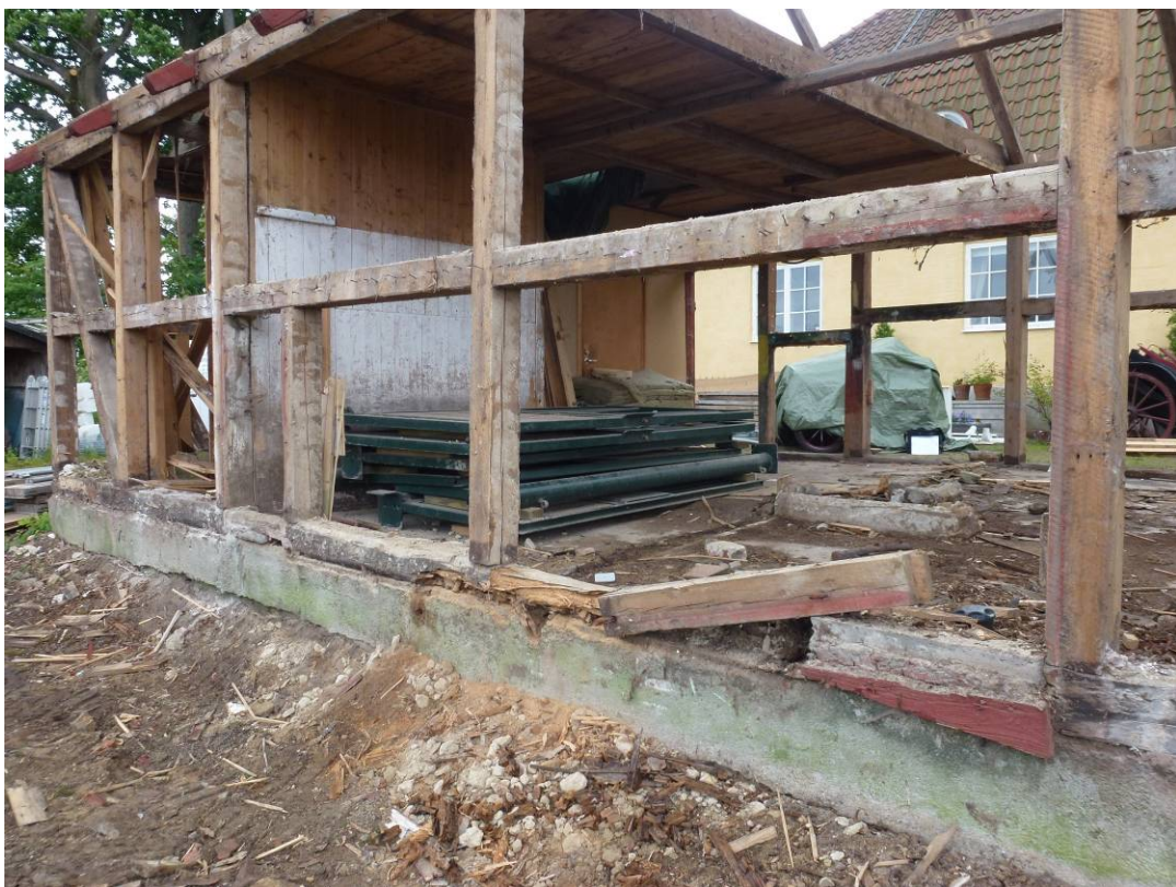
Stommen är frigjord, före rivningen. Norra sidan med kraftigt rötskadad syll och rötskadade stolp-ändar.
