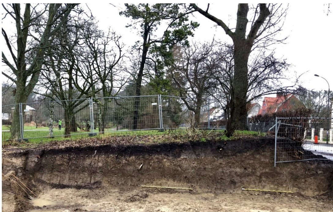
Figur 4. Fotografiet visar svårigheterna med att se lagerskillnader i sektionen av vallen. Fotot är taget ifrån söder.
