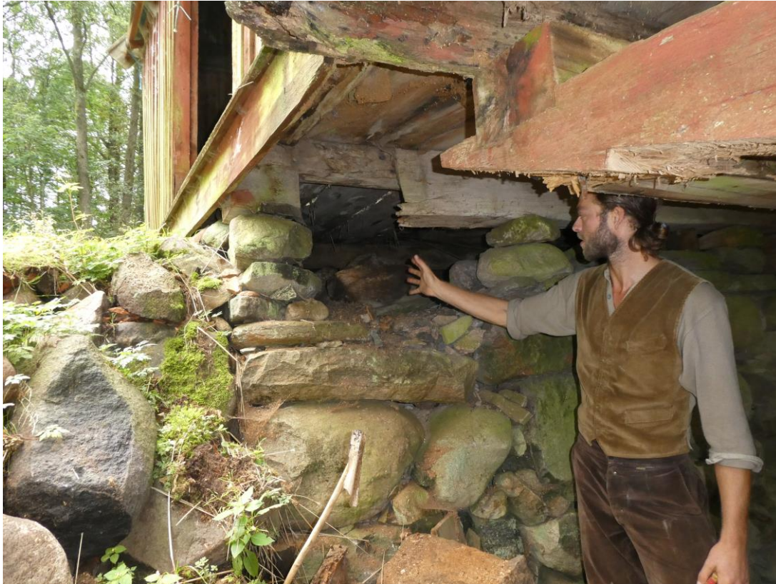
Under arbete. Skadad undersyll bortplockad.
