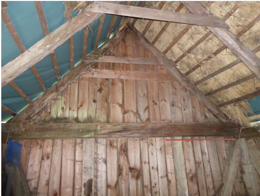
Före åtgärder. Rötskadad lejd i det sydvästra hörnet.
