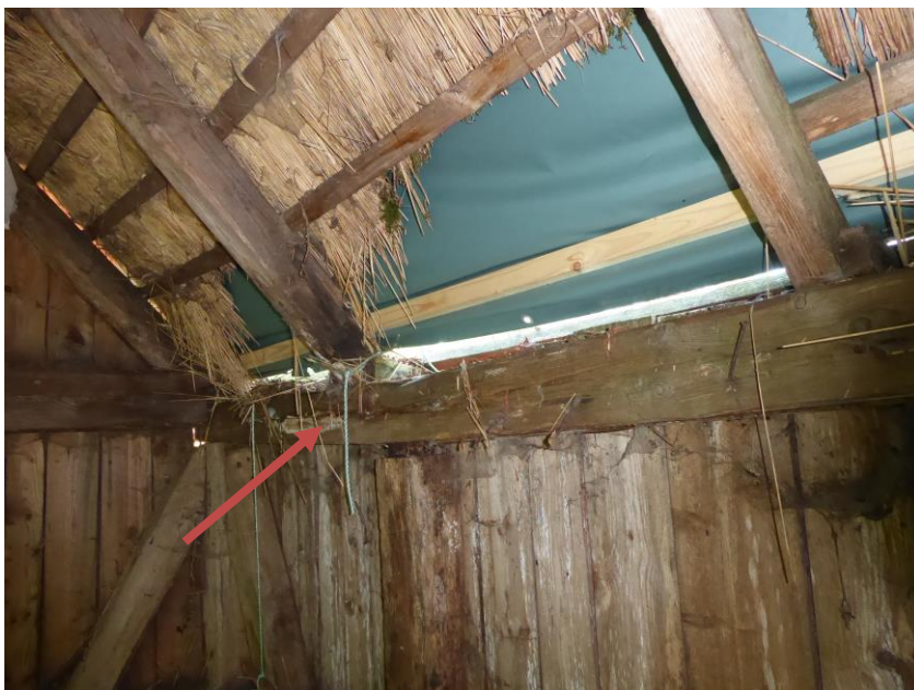
Före åtgärder. Västra långsidan. Rötskadad lejd lång sidan
