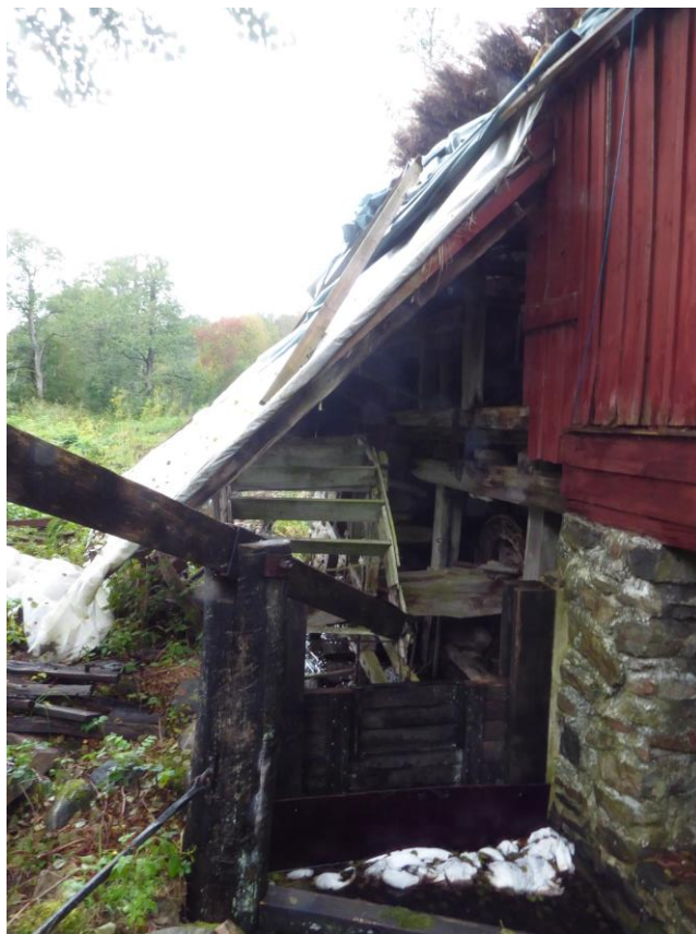
Före åtgärd. Skärmtaket hade hasat ner på grund av rötskador.
