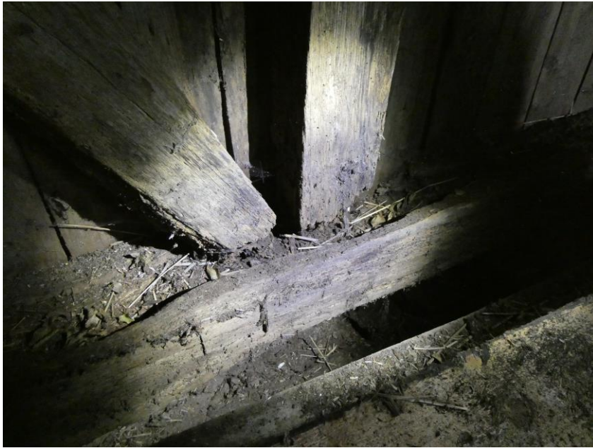
Före åtgärder. Mellan syll och stolpar på västra långsidan fanns glipor.
