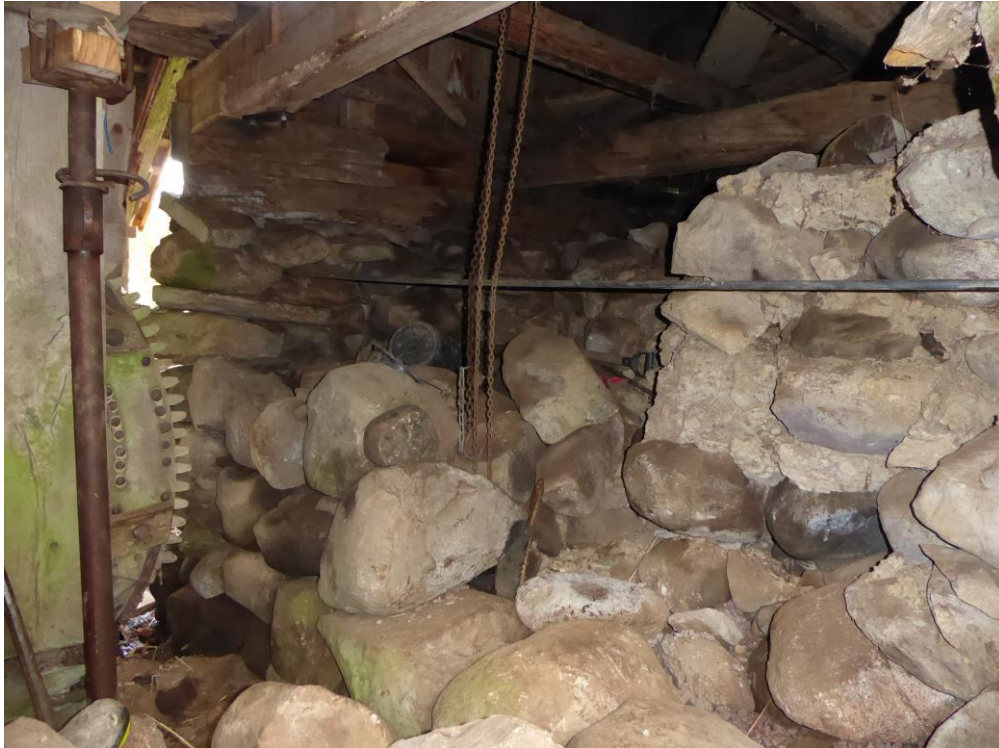
Under åtgärd. Byggnaden rätades upp och ankarjärn sattes i stensockeln. Lerpackning och lerbruk kan anas mellan stenarna till höger på bilden
