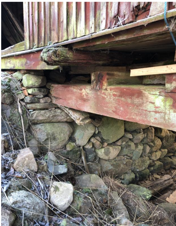
Före åtgärder. Syllen var upprutnad och hade fallit ur sitt läge. Fotografi av fastighetsägaren.
