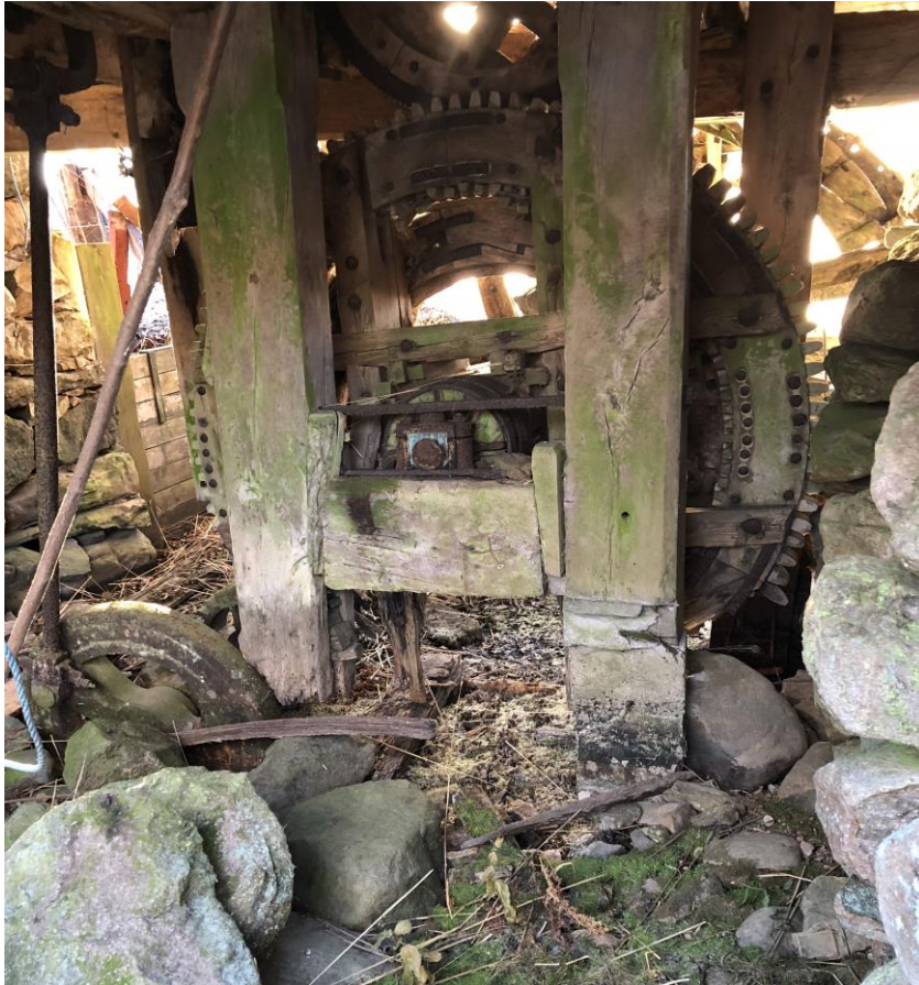
Före åtgärder. Stolpar vid undersågen var ruttna och hängde fritt. Fotografi av fastighetsägaren.
