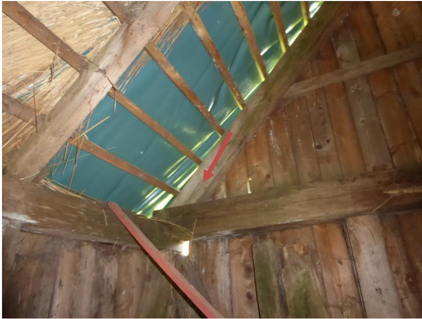
Före åtgärder. Skadad lejd i gaveln.
