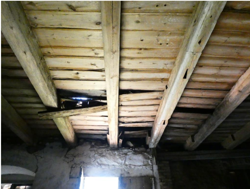
Före åtgärd. Skador på bjälkar lagda i muren. Entrén vid sydöstra fasaden.
