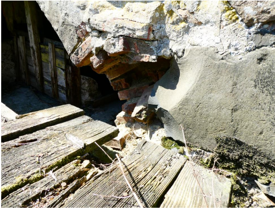
Före åtgärd. Cementlagning och skador i tegelvalv vid sydöstra fasaden.
