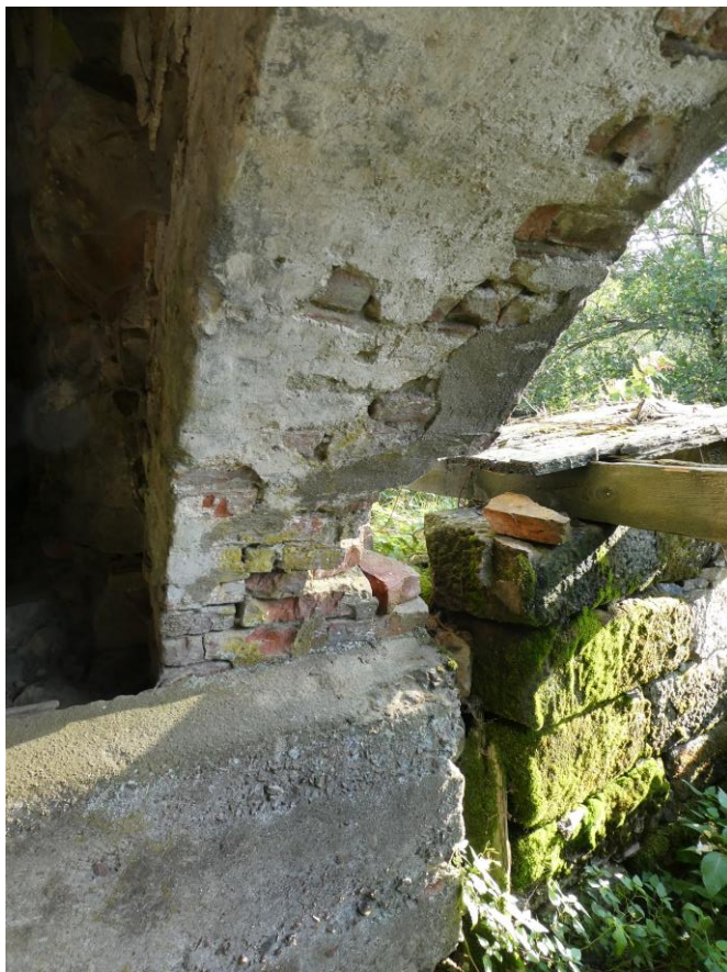
Före åtgärd. Skada på valv vid sydöstra fasaden.
