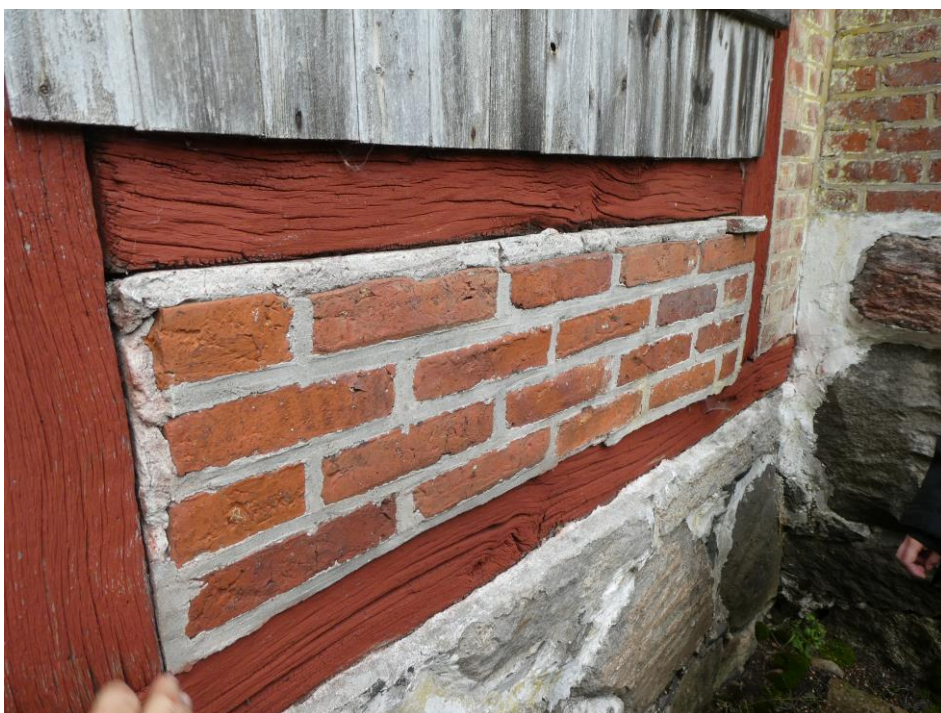
Före åtgärd. Cementmurbruk och släpp mellan fack och timmra i korsvirkesdelen.
