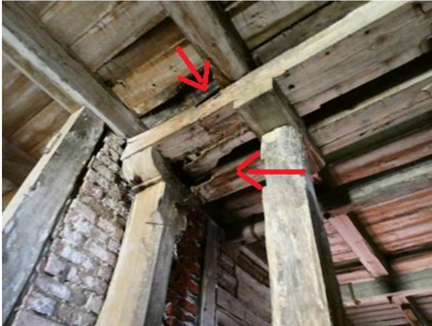
Före åtgärd. Brott på bjälke som stabiliseras upp med en i senare tid uppsatt pelare.
