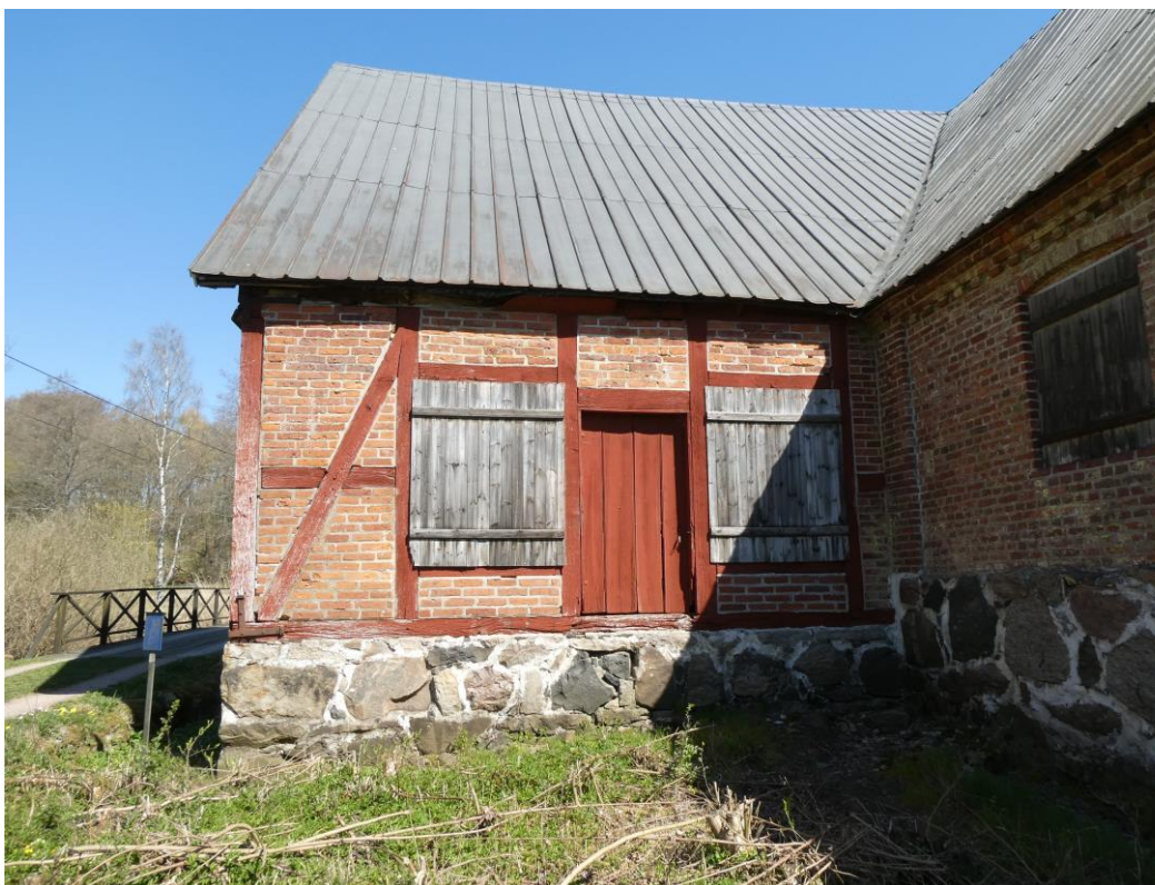
Före åtgärd. Västra sidan. Tegelfacken under brädluckorna är det aktuella.
