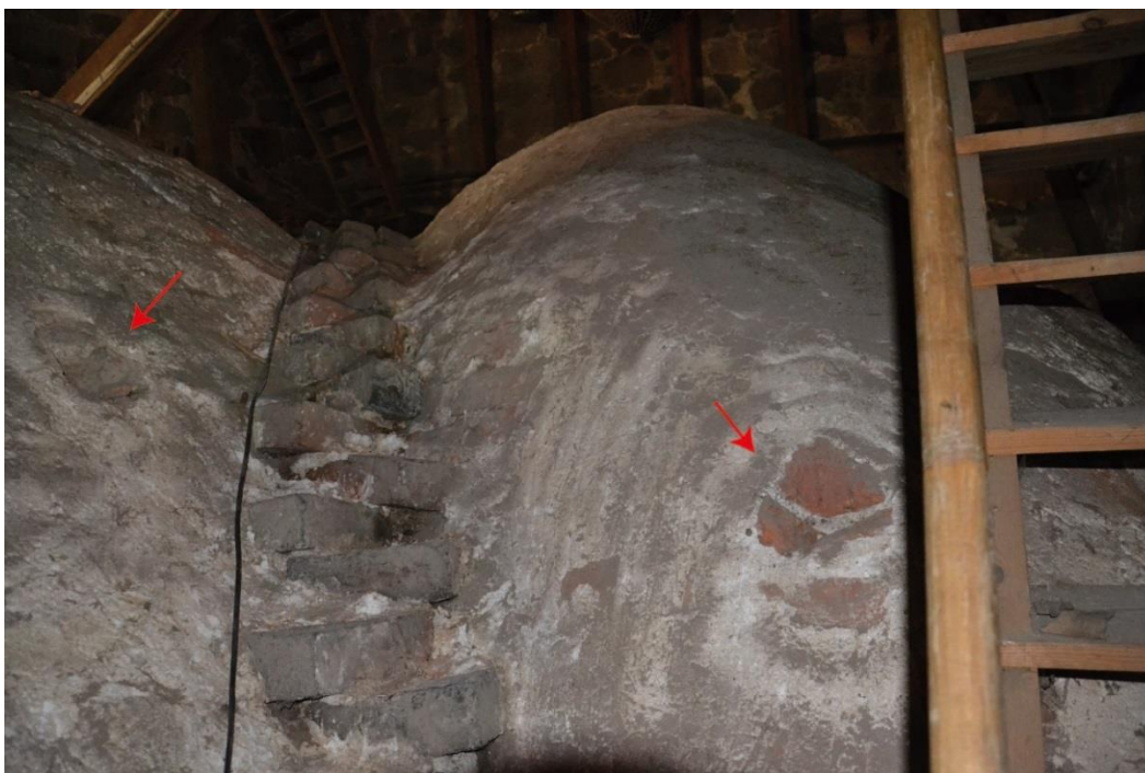
Figur 78. Det finns flera hål i valvkapporna mot norr.
