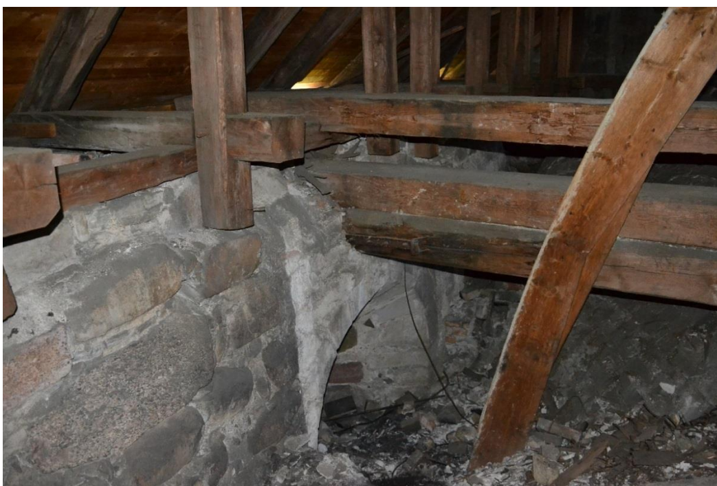
Figur 62. Ett avtryck efter en konstruktion syns som en vertikal ljus färgning intill det romanska fönstret i södra väggen. Motsvarande avtryck finns i norra väggen med samma placering. Det kan höra samman med de kaminer som tidigare funnits i kyrkan.
