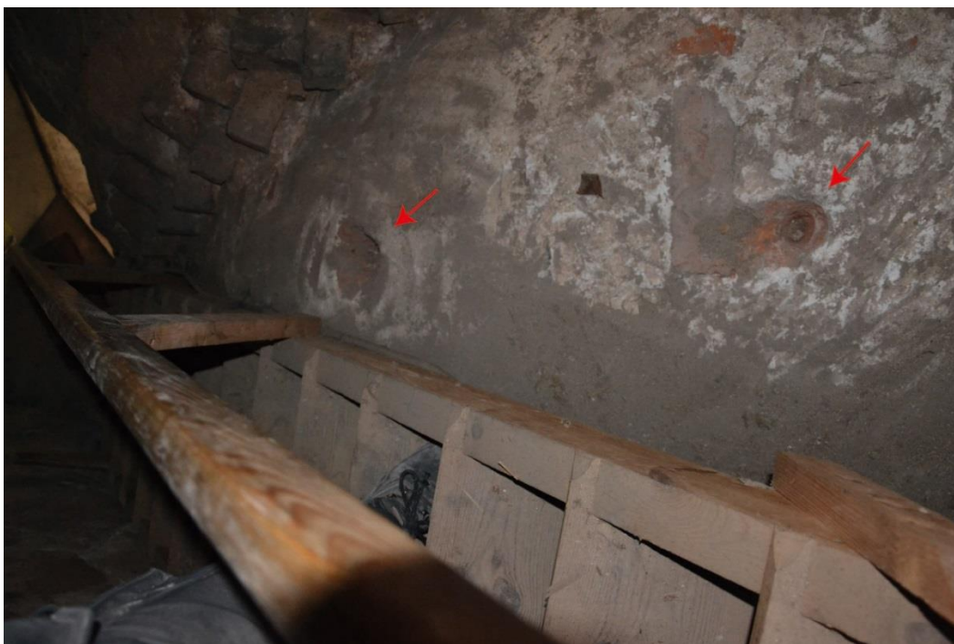
Figur 80. Det finns flera hål i valvkapporna mot norr.
