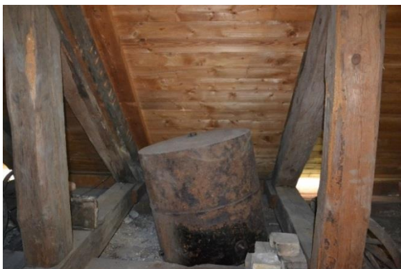
Figur 39. Valv 4, koret. Ett äldre expansionskär som hör samman med kyrkans värmeanläggning förvaras på vinden.
