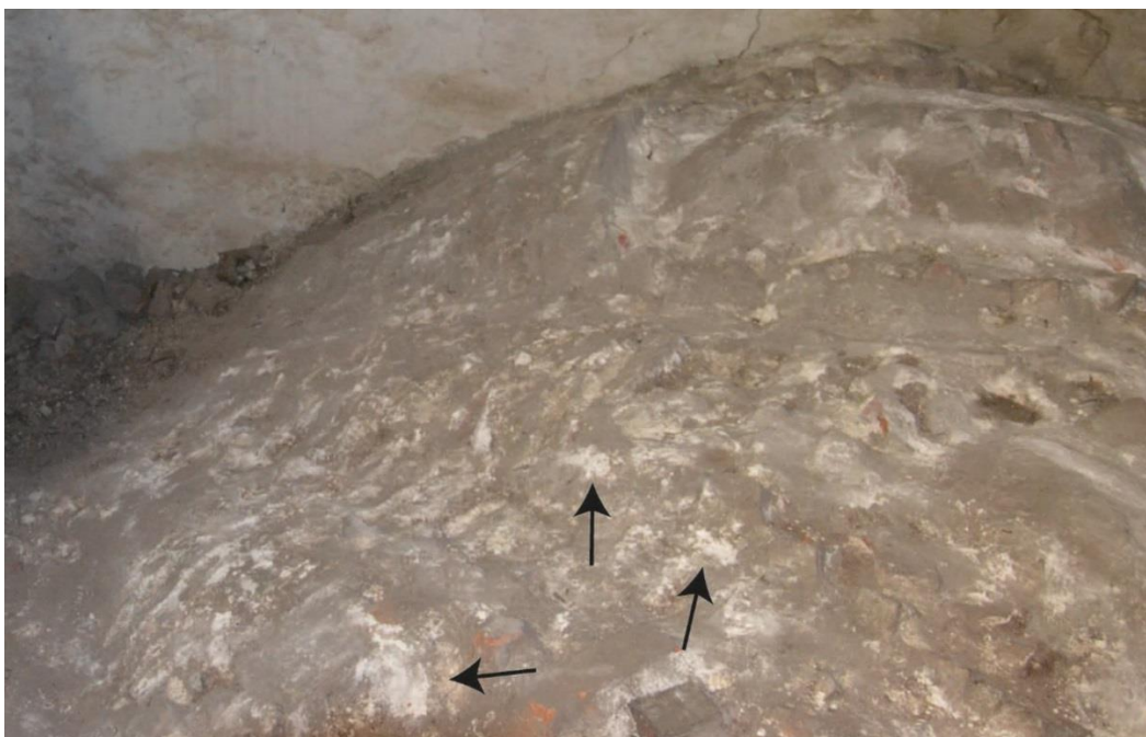
Figur 54. Fogarna i korets valv har luckrats upp och deras ursprungliga utformning går inte längre att se. Pilarna visar endast några exempel.
