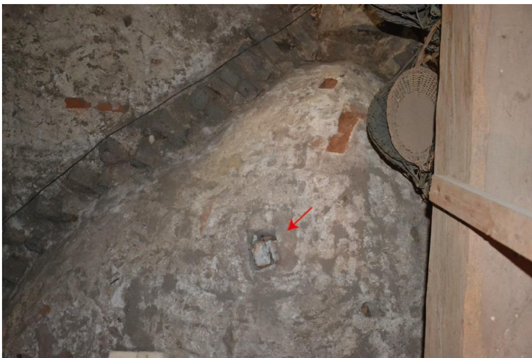
Figur 79. Det finns flera hål i valvkapporna mot norr.
