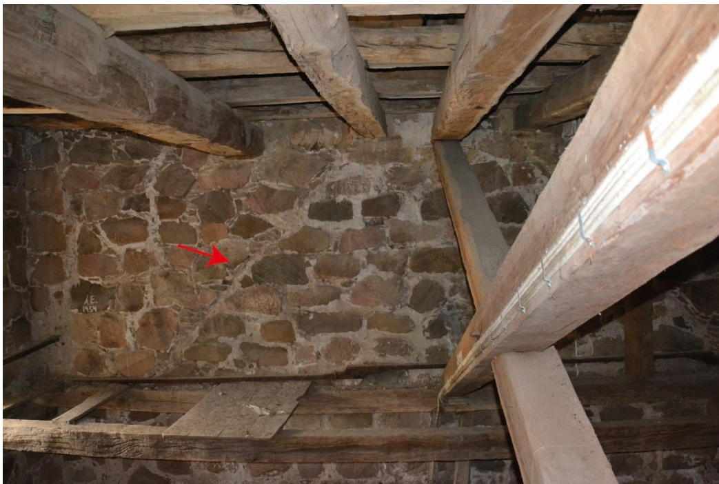
Figur 72. I östra tornväggen syns långhusets västra gavel. Dragstag av järn har sattes in 1857 för att stabilisera tornet som verkar ha lidit av instabilitet sedan det byggdes (Wikerstål arkitekter 2008, s 47).
