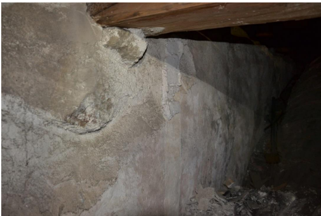
Figur 63. Mellan valven i långhuset på norra väggen finns färgskiftningar i putsen. Det ser också ut som ett avtryck efter någon konstruktion som syns som en vertikal rand i putsen.
