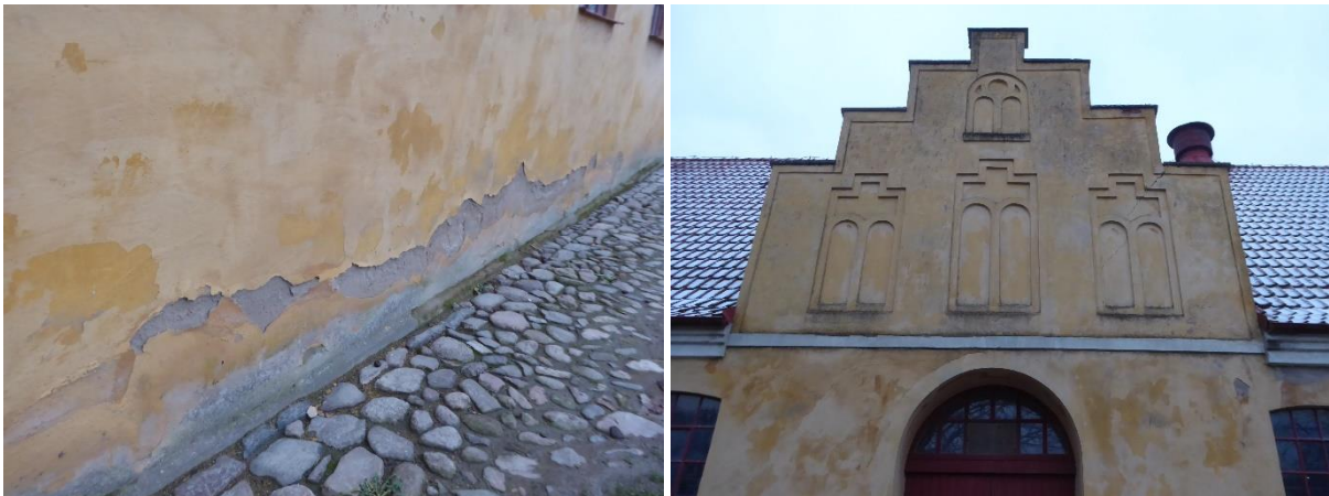
Figur 2. Före åtgärder. Exempel på skada på fasad och sockel. Trappgaveln, notera sprickan i blindingen till höger i bild, den vita listen samt portomfattningen.
