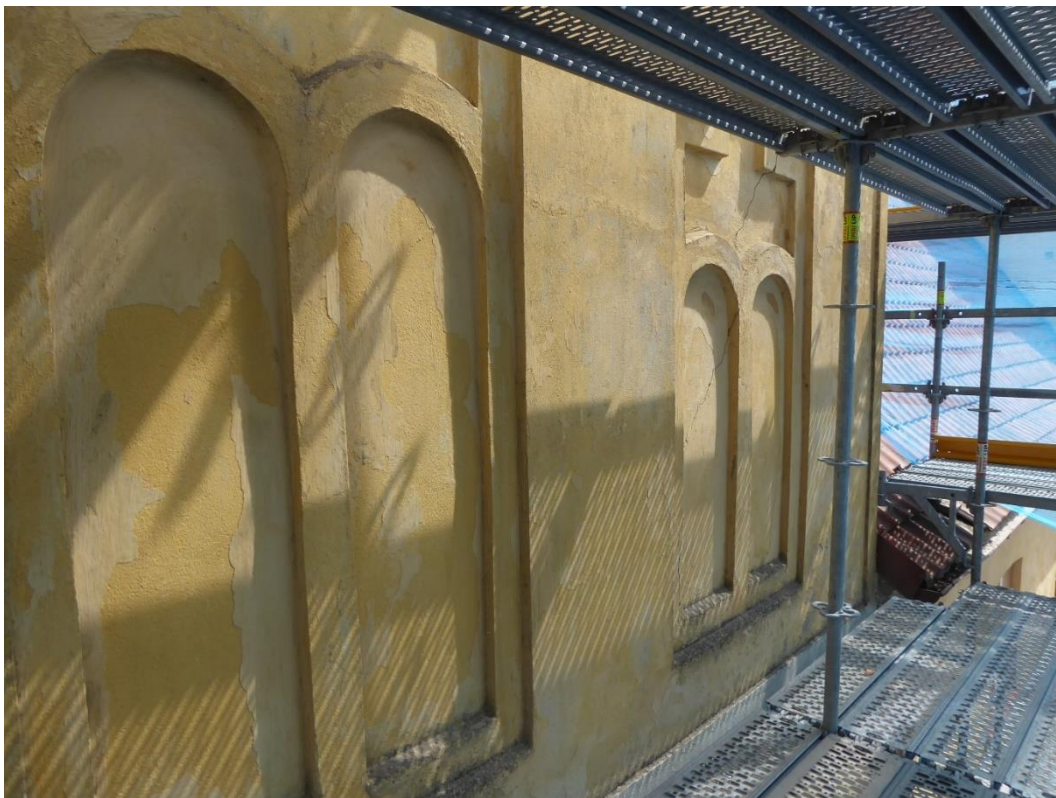
Figur 3. Blinderingar före åtgärderna, spricka längst till höger i bild.
