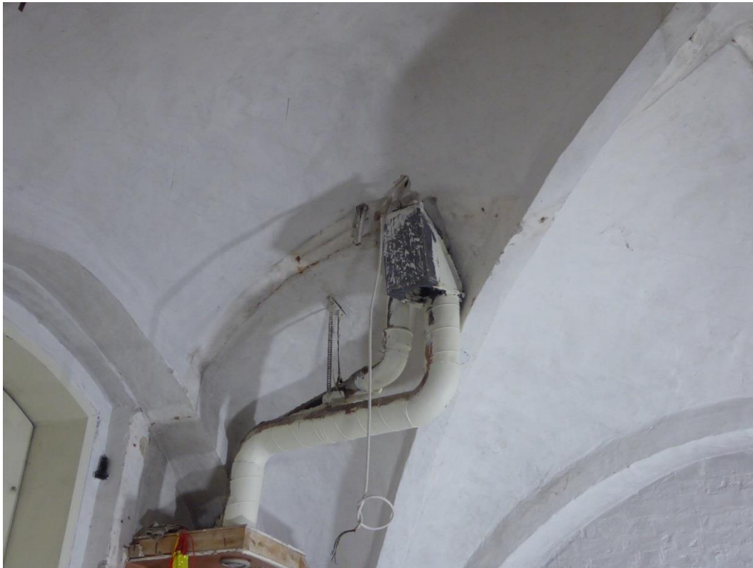
Äldre genombrott i östra valvet östra valvkappan. Detta hål vidgades då ytterligare enstaka sten plockades ut.
