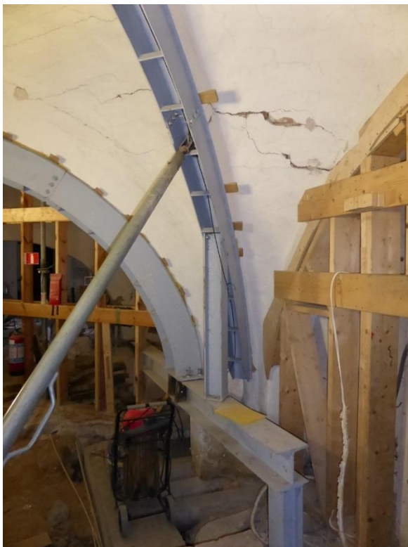
Sprickor i valven norra muren, östligaste valvet.
