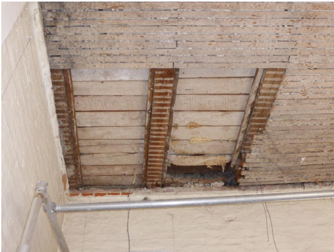
Byggnadens nordvästra hörn. Bjälklaget mellan vind och övre våning sett underifrån, spräckpanelen på bilden är nu helt borttagen bortsett från ett mindre parti i byggnadens sydöstra hörn. Notera de gulaktiga fruktkropparna.
