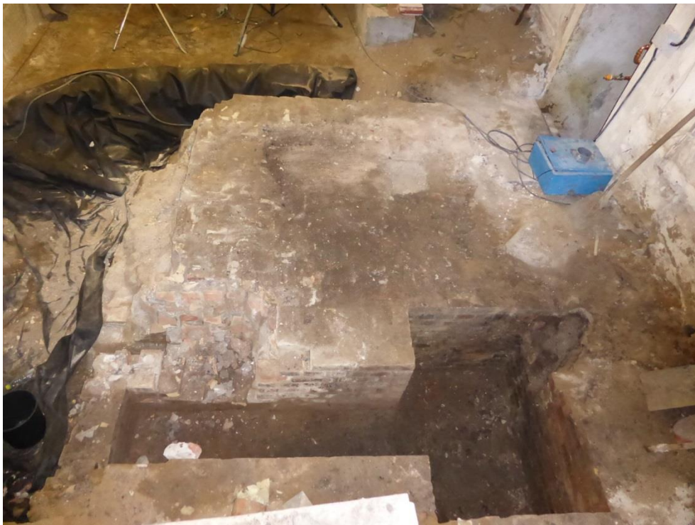
Den sockel i tegel som bilades bort för att ge utrymme åt trappliften och att frilägga intilliggande grundkonstruktion och utesluta att syresatta komprimerade kulturlager lämnat håligheter som kan medföra ytterligare sättningar.
