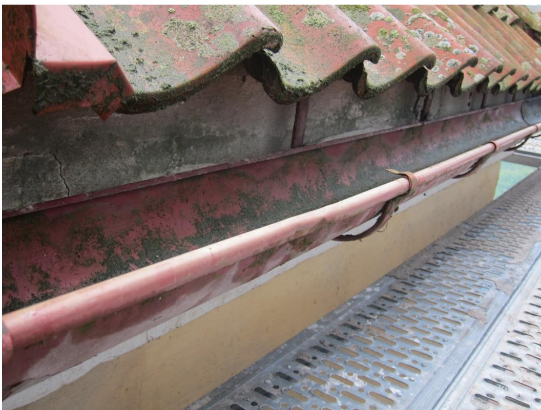
Före åtgärder, rödfärgat nockbruk och upphängning av hängränna.
