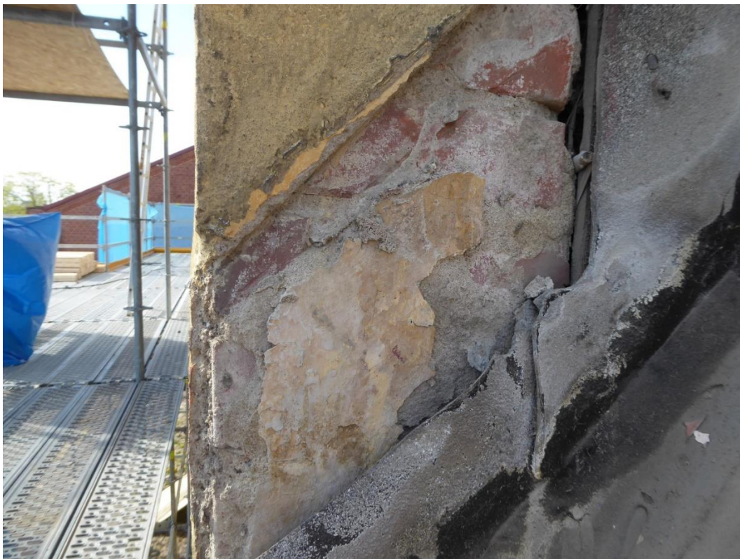
Puts och färgrester på frontespis mot öster.
