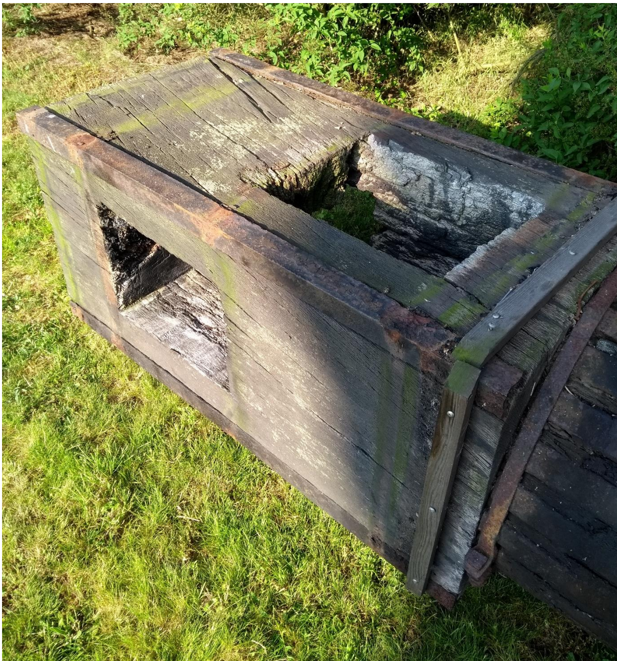
Foto av det rötskadade axelhuvudet.
