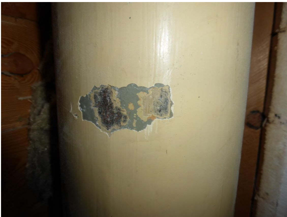
Färgspår på gjutjärnspelare, ockragult och grå nyanser
