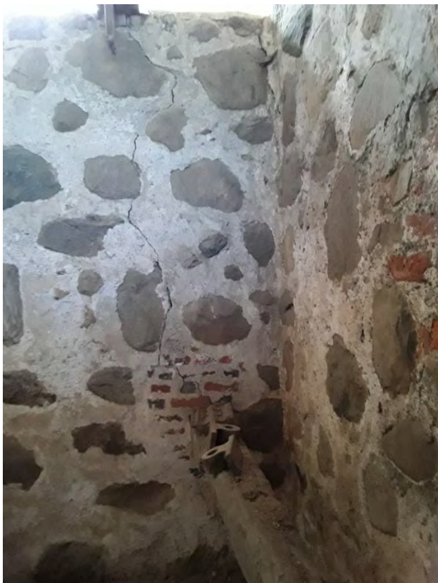
Figur 34. Murverket i tornet består av natursten där bruket strukits ut över stenarna. Bjälken kan vara utbytt då den omges av ett ganska stort parti tegel. I detta område finns en spricka.
