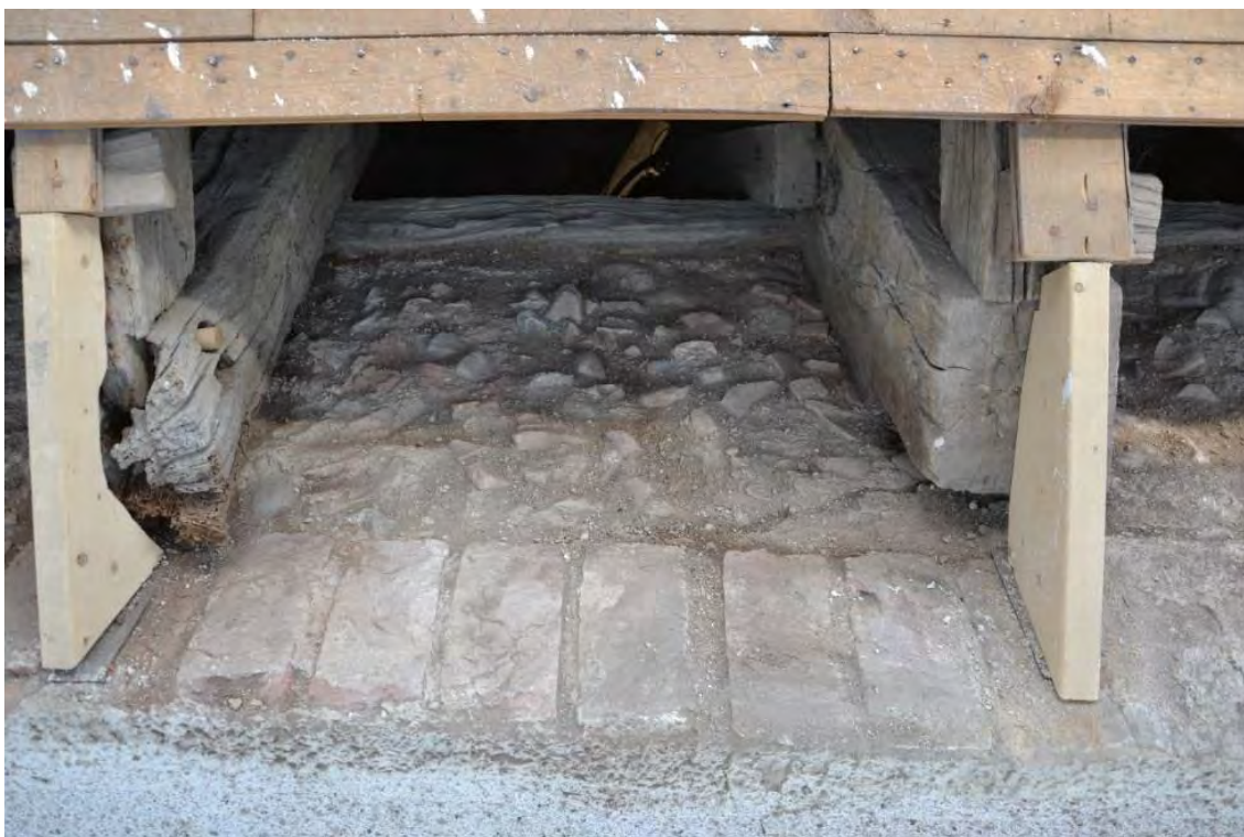
Figur 12. Efter den arkeologiska städningen var murkrönet fritt från diverse organiskt material som skadat delar av träkonstruktionen, framförallt remstyckena.
