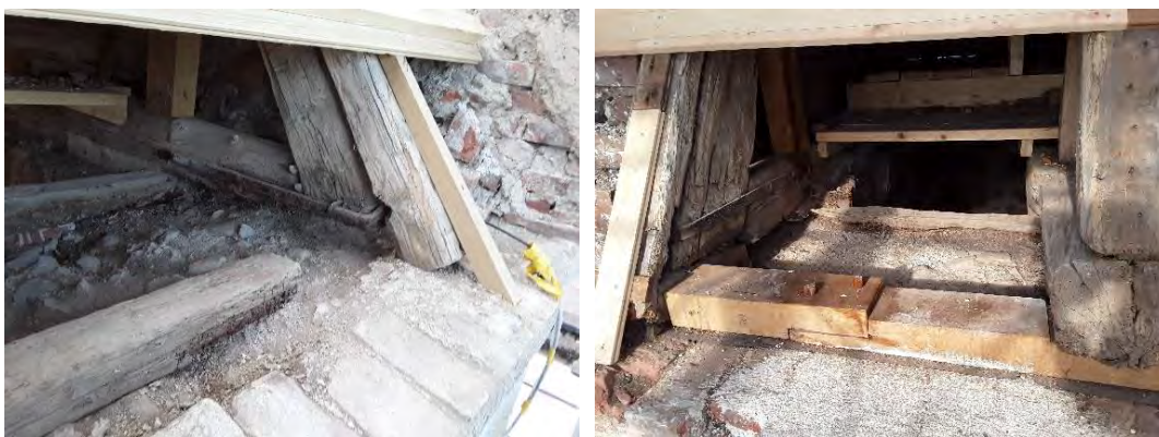
Figur 30. Mot gaveln har dragjörn satts in för att hålla samman konstruktionen. Det är oklart när dragjärnen har satts in. Möjligen har det skett i samband med att klockan gjutits om år 1811 eller år 1955.
