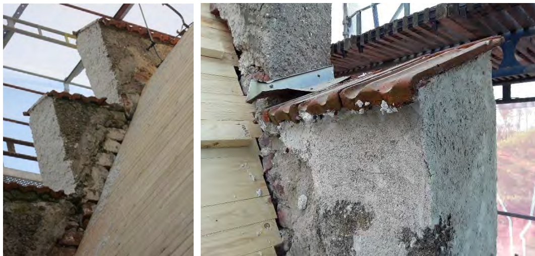
Figur 27. Takvinkeln har någon gång ändrats och trappstegsgaveln murats om och försetts med nya takpannor.
