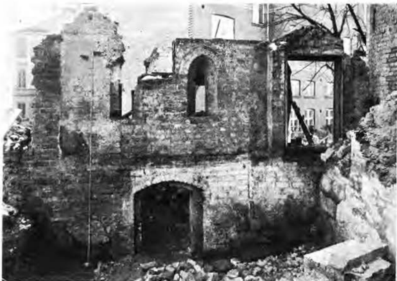
Bild 13. I norra väggen i dekanresidensets äldsta del upptäcktes vid rivningen 1908 två spetsbågiga fönster i första våningen. Väggen är här sedd från norr sedan tornet D rivits.
