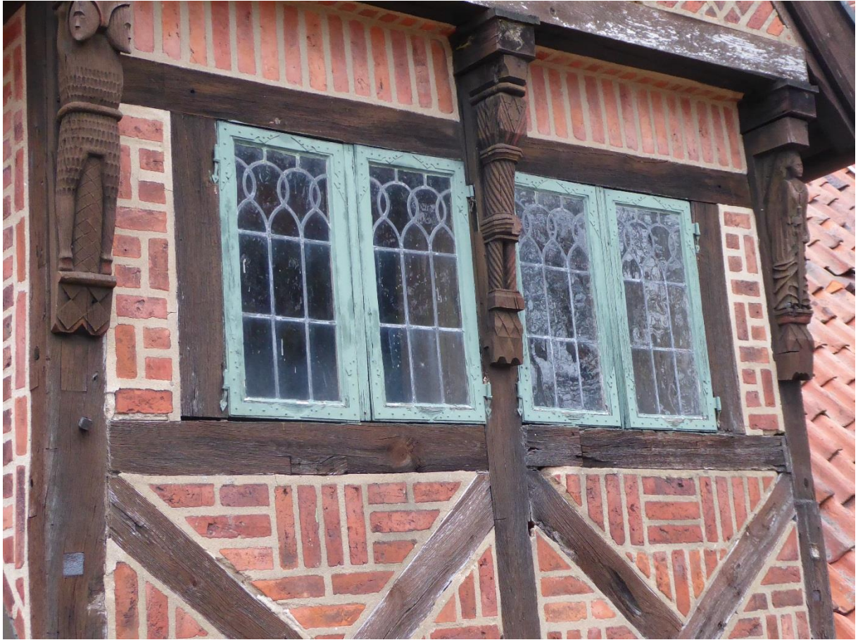
Fönstren på takkupa åt söder. Något av facken behöver tas ned och muras om. Timra i behov av målning.
