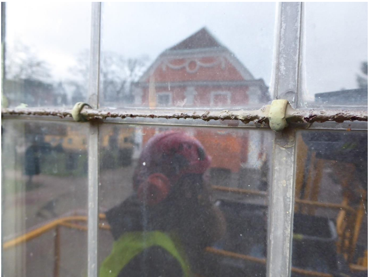
Flera av stormjärnen på fönstren är väldigt angripna av rost och nästan avrostade.
