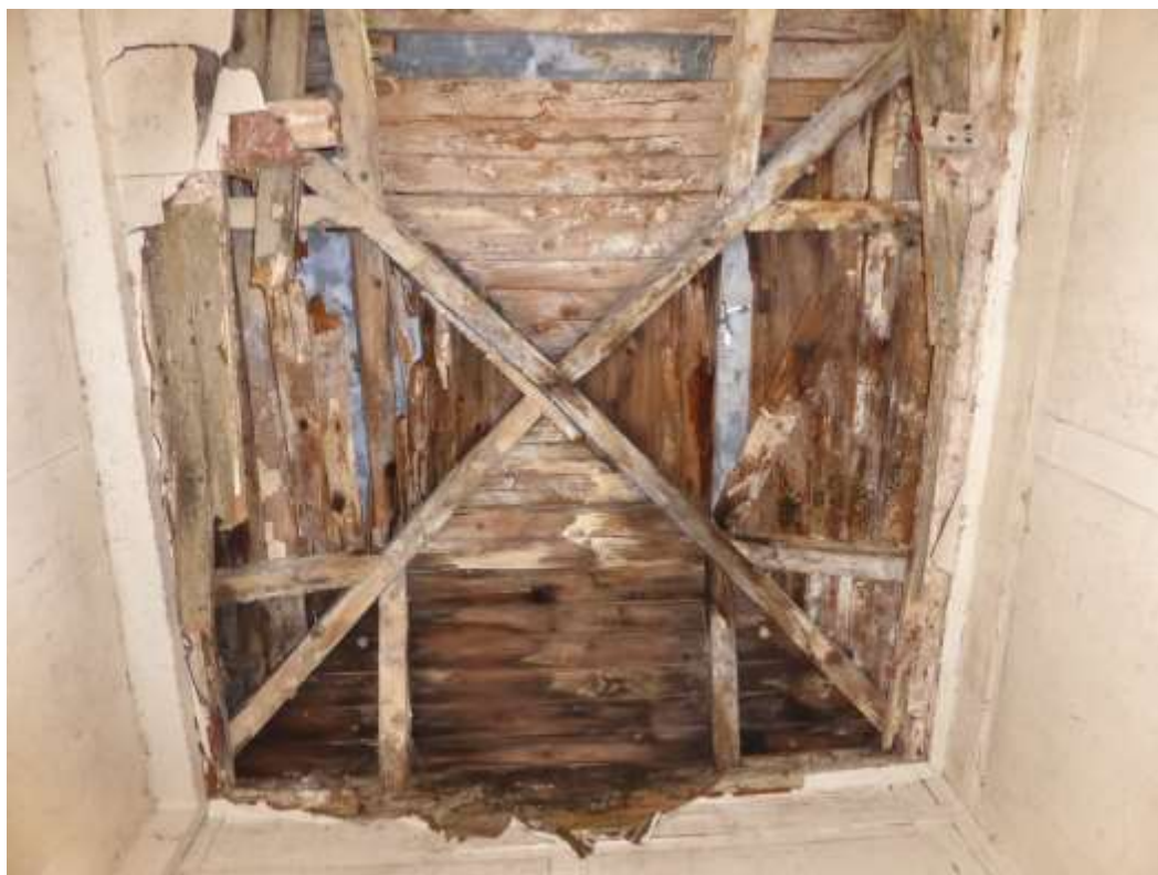
1 Innertaket före åtgärder.
