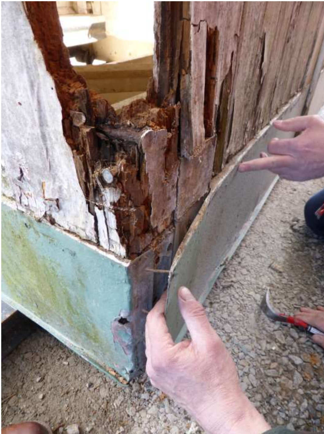
3 Byggnadsundersökning med antikvarisk medverkan vid entreprenadstart. Byggnaden var som väntat i mycket dåligt skick.
