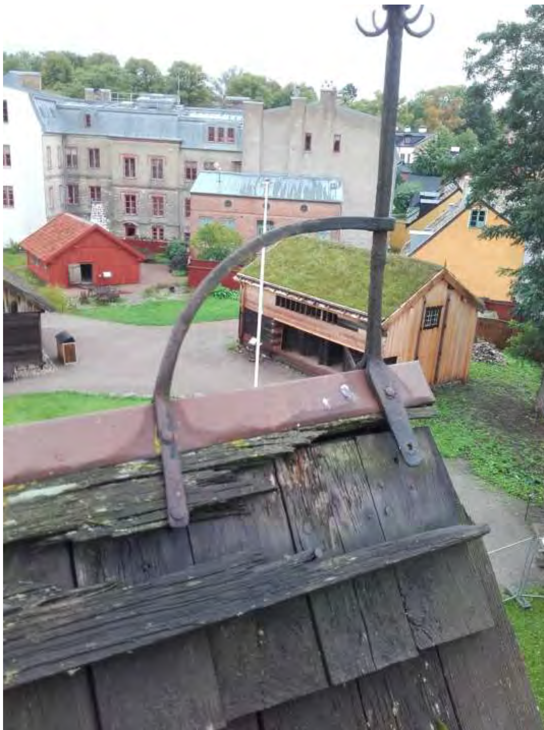
5. Upprutennockbräda och tidigare infästning av vindflöjel. Plåten har ersatts med näver under nockbrädorna.
