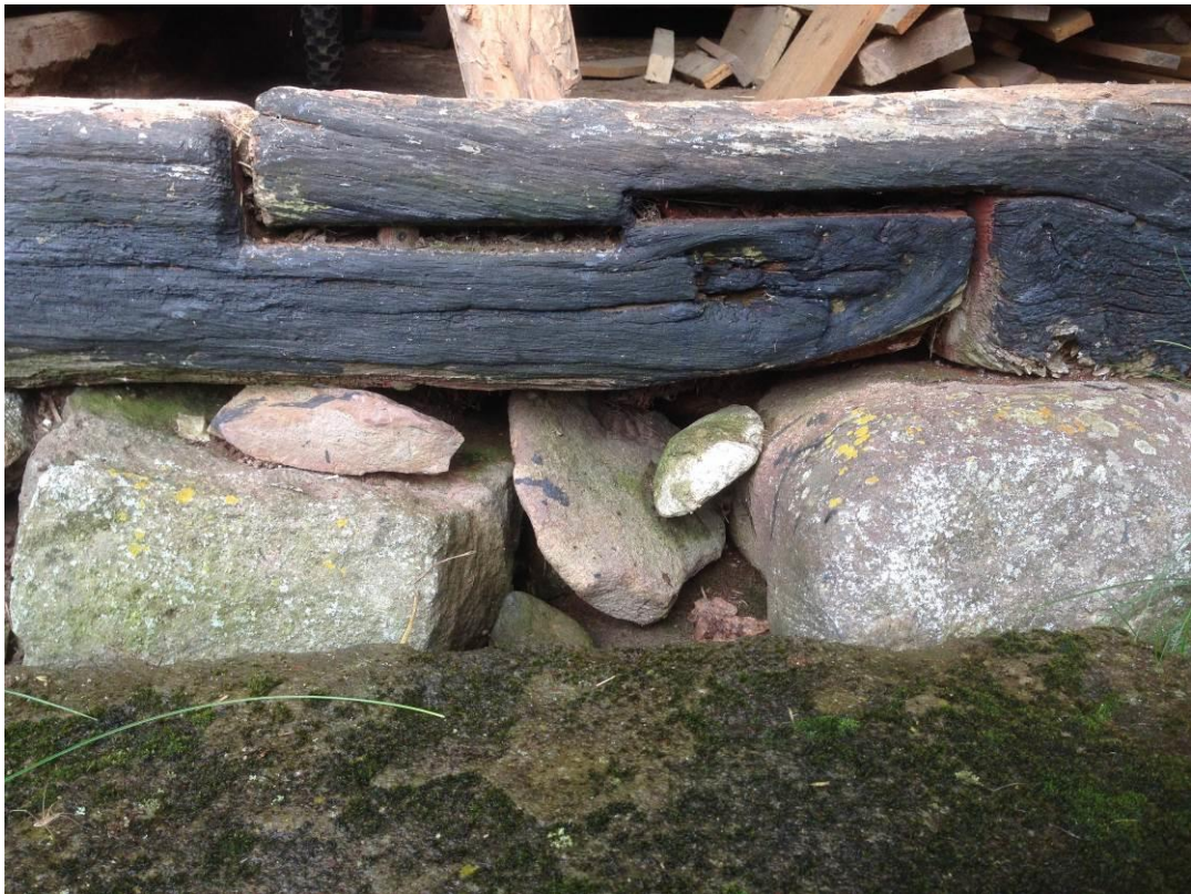
Figur 10. Exempel på befintlig skarv i byggnaden, halvt i halvt med hak. I skarven är den övre syllen något klenare än den undre. Denna skarv har inte åtgärdats utan finns kvar i byggnaden.
