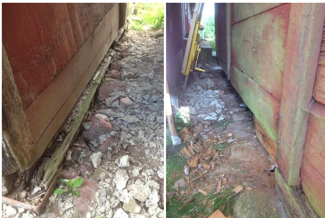
Figur 19 – 20. Under arbete. Vänster: Kraftigt rötskadad syll och hörnstolpe i nordöstra hörnet. Höger: Skadad syll är borttagen i de två östra facken. Syllen kommer att skarvas halvt i halvt i anslutning till stolpen till höger i bild.
