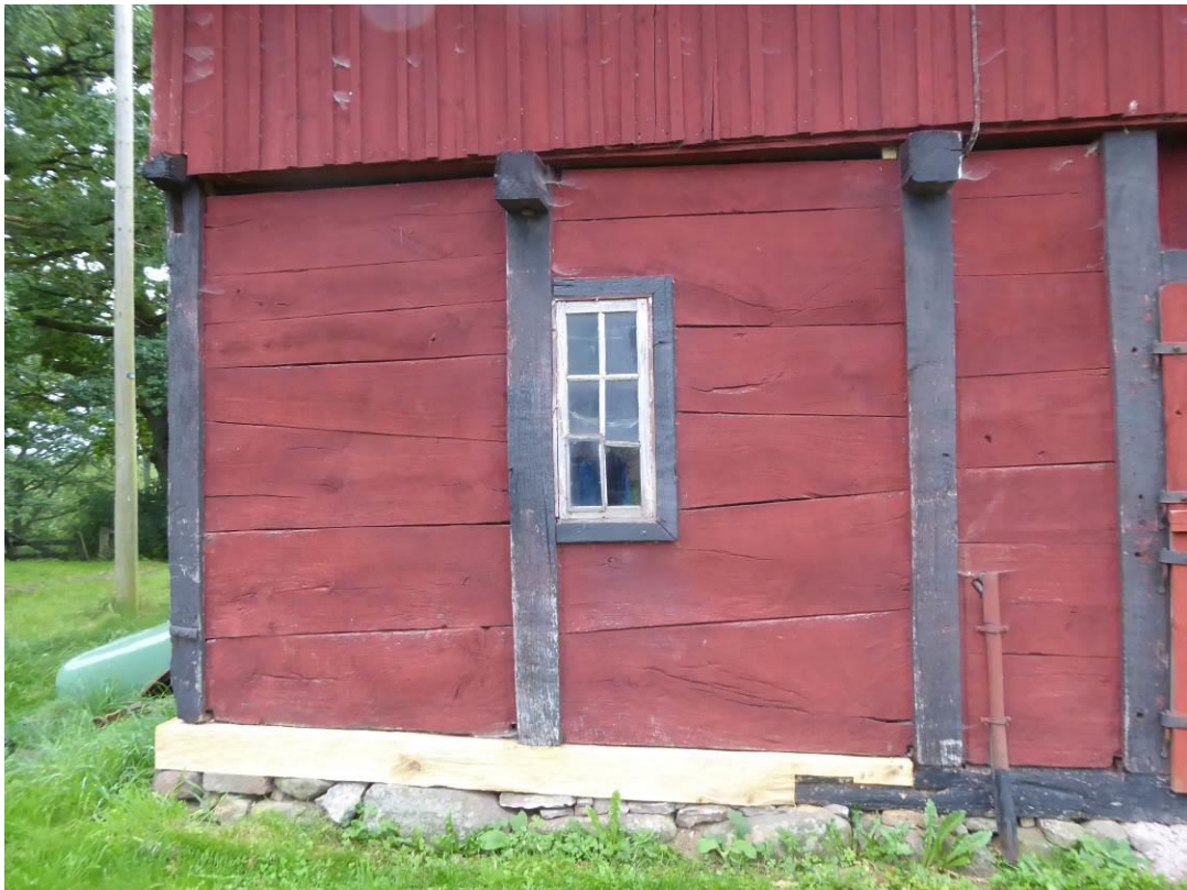
Figur 8. Efter åtgärder. Sydöstra hörnet.
