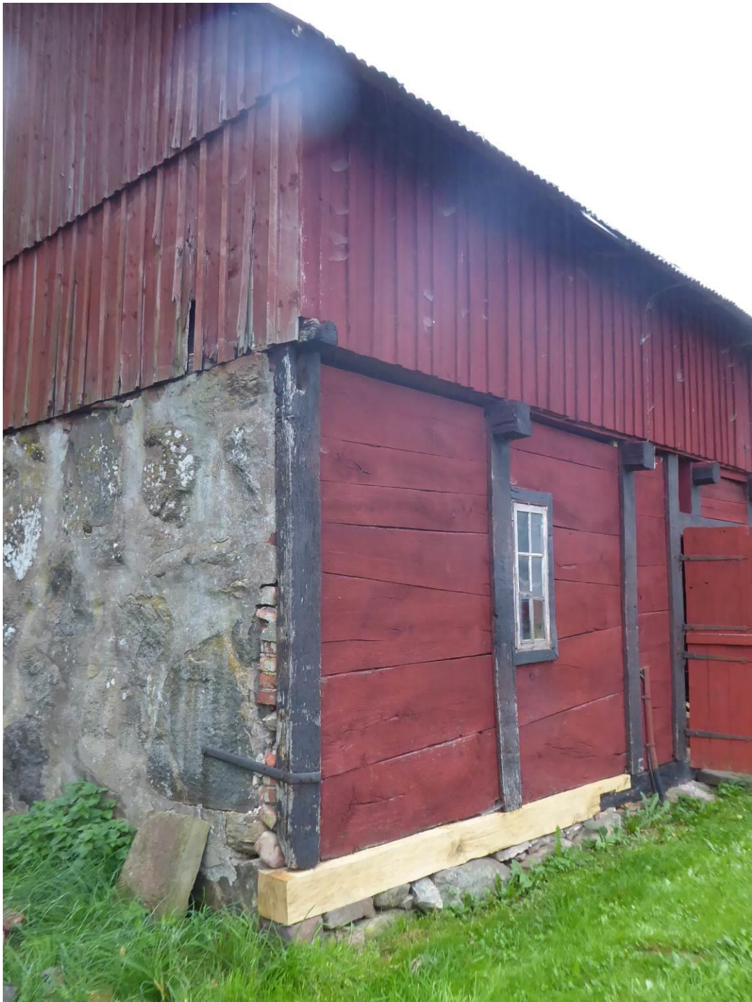
Figur 7. Efter åtgärder. Sydöstra hörnet.
