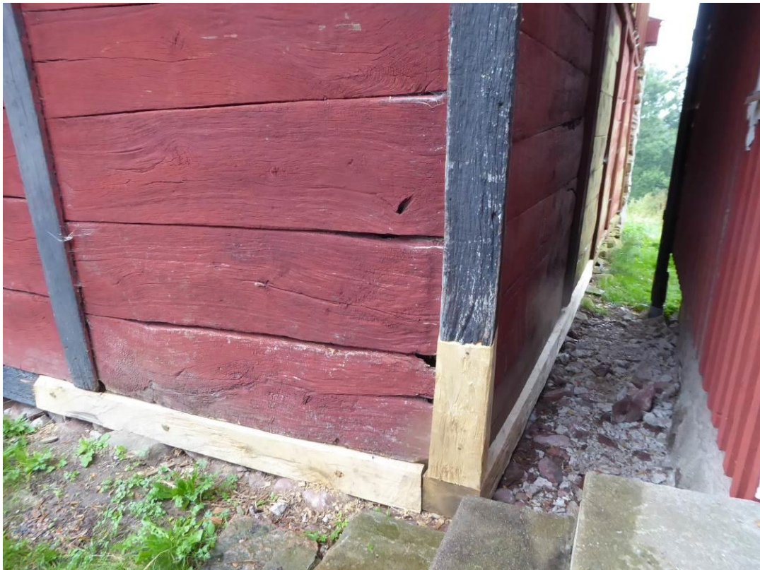
Figur 23. Efter åtgärder. Nordöstra hörnet. Syllen till vänster i bild är lagad halvt i halvt och dubben syns som små mörkare fält. Hålen är borrade snett uppåt.
