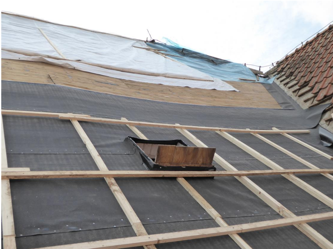
Under arbete. Längst i väster har taket en dal på grund av att takstolen saknade stödben. Taket har riktats med hjälp av läkt.
