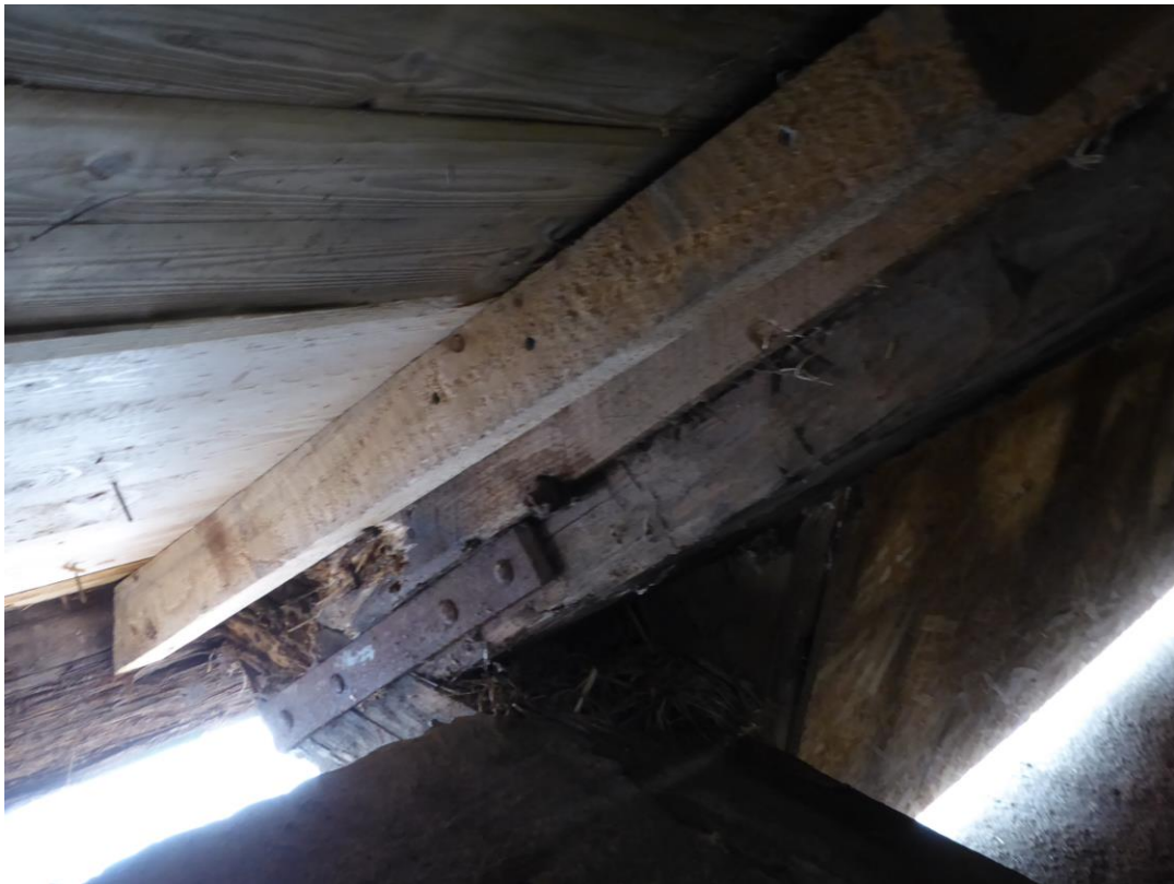
Den rötskadade takstolen är förstärkt med en bräda, samt mindre lagning i takpanelen (ljusare panel på bilden). Järnet som binder sparren och takbjälken är ursprungligt.
