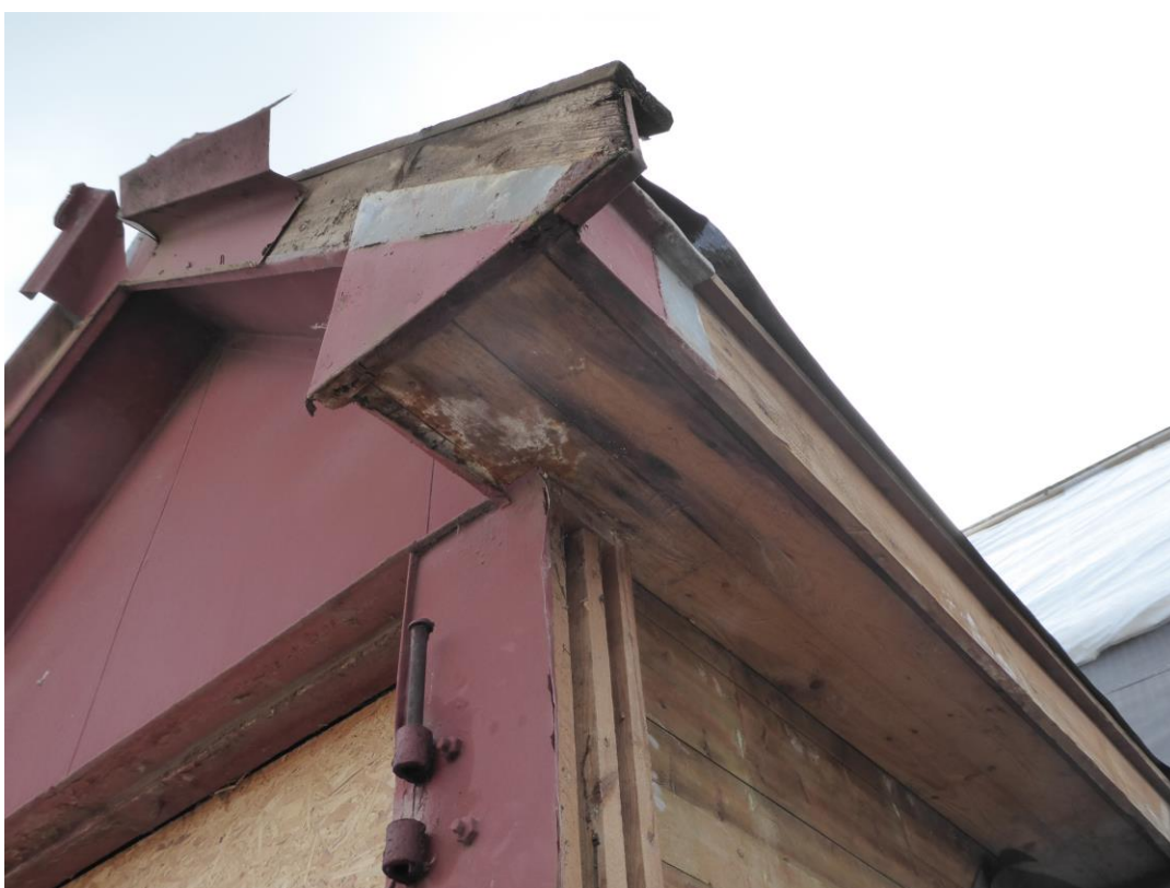
Under arbete. Mindre fuktskador på takluckor.
