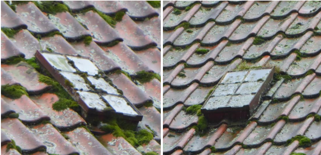
Takfönster före åtgärder. Två av gjutjärnsfönstren på taket.
