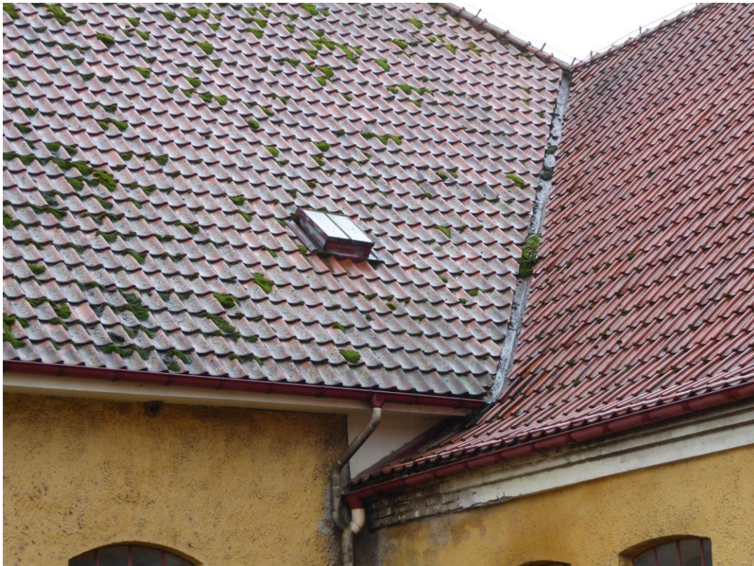
Före åtgärder. Hängrännor, stuprör, takfönster med två glasrutor och rännal vid takmöte i väster, det aktuella takfallet till vänster i bild.
