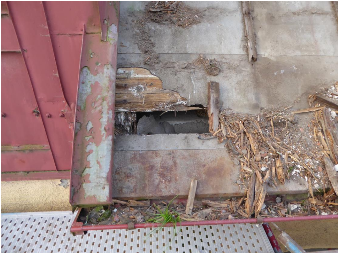
Under arbete. Rötskadad taksparre och panel invid en av kuporna. På bilden ser man även den gamla fotplåten, pappen och hängränna.
