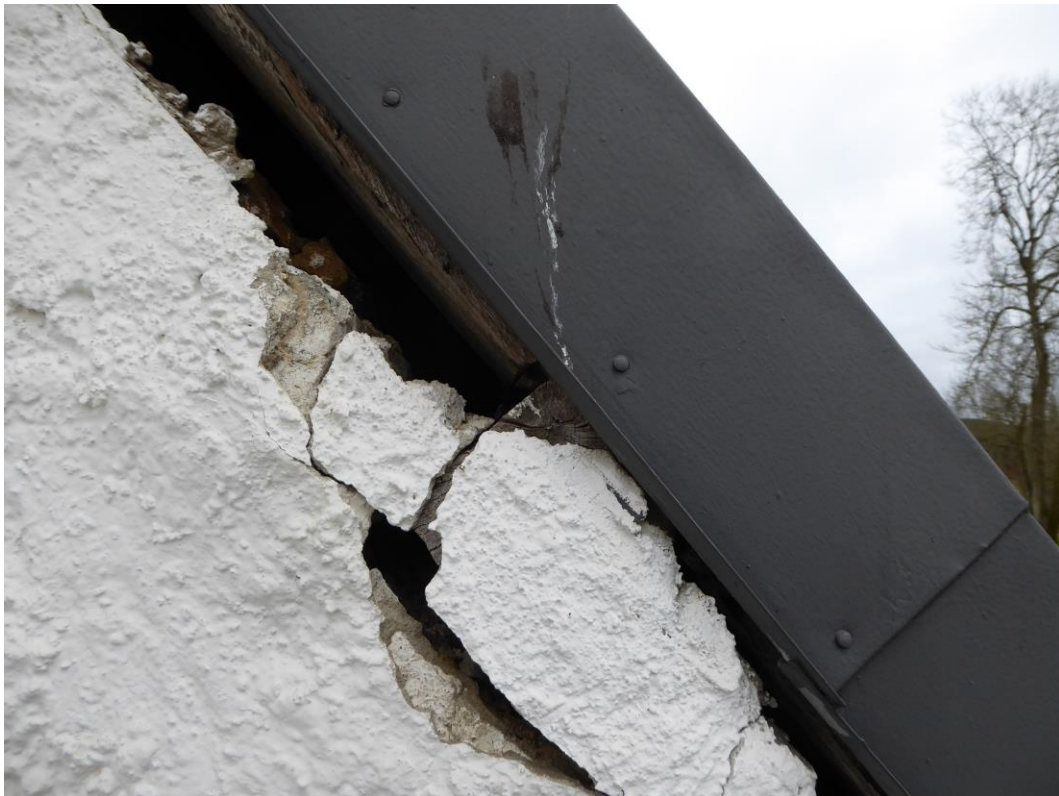
Före åtgärder. Avtäckning och bjälklagskonstruktion hade börjat kasat ner.
