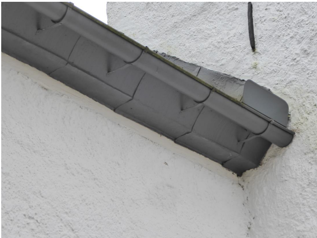
Figur 5. Före åtgärder. Nykyrkans takfot åt väster.
