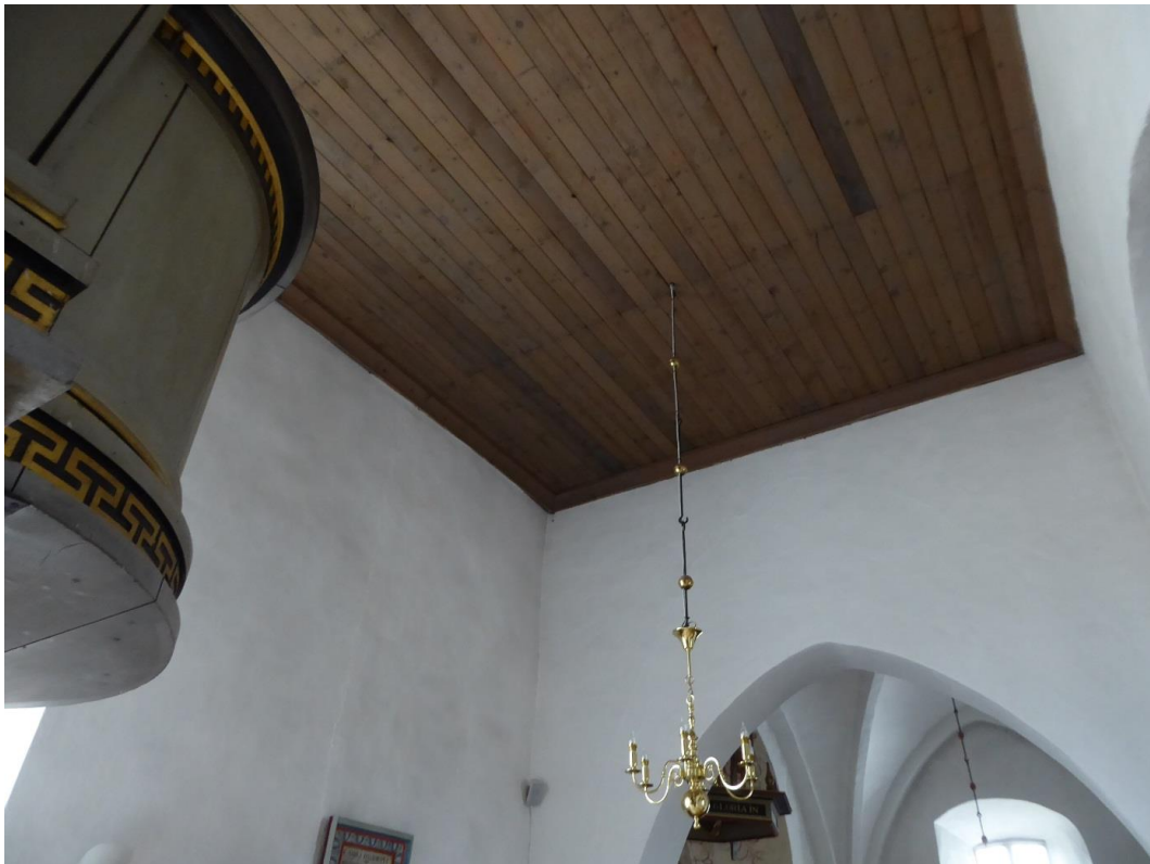
Figur 2. Före åtgärder. Nykyrkans tak vy mot långhuset.
