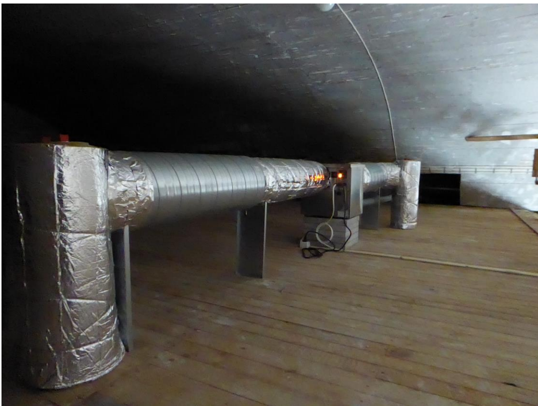
Figur 9. Efter åtgärder. Sorbtionsavfuktaren på vinden.
