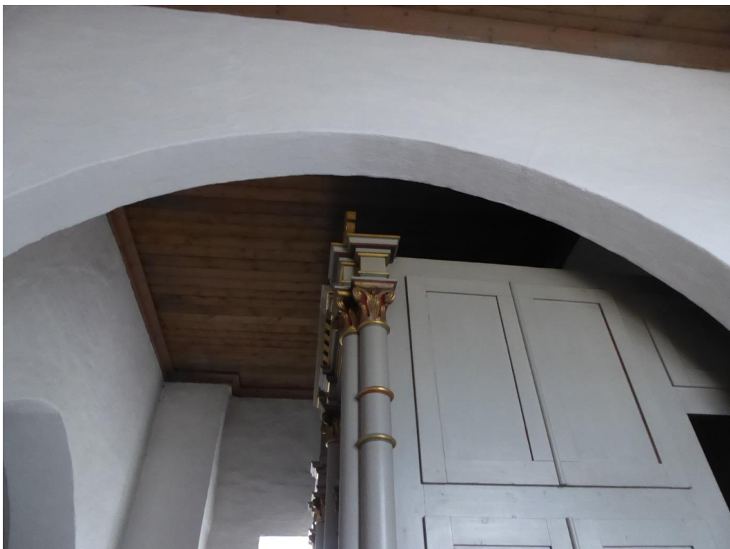
Figur 3. Före åtgärder. Nykyrkans tak vid orgeln.
