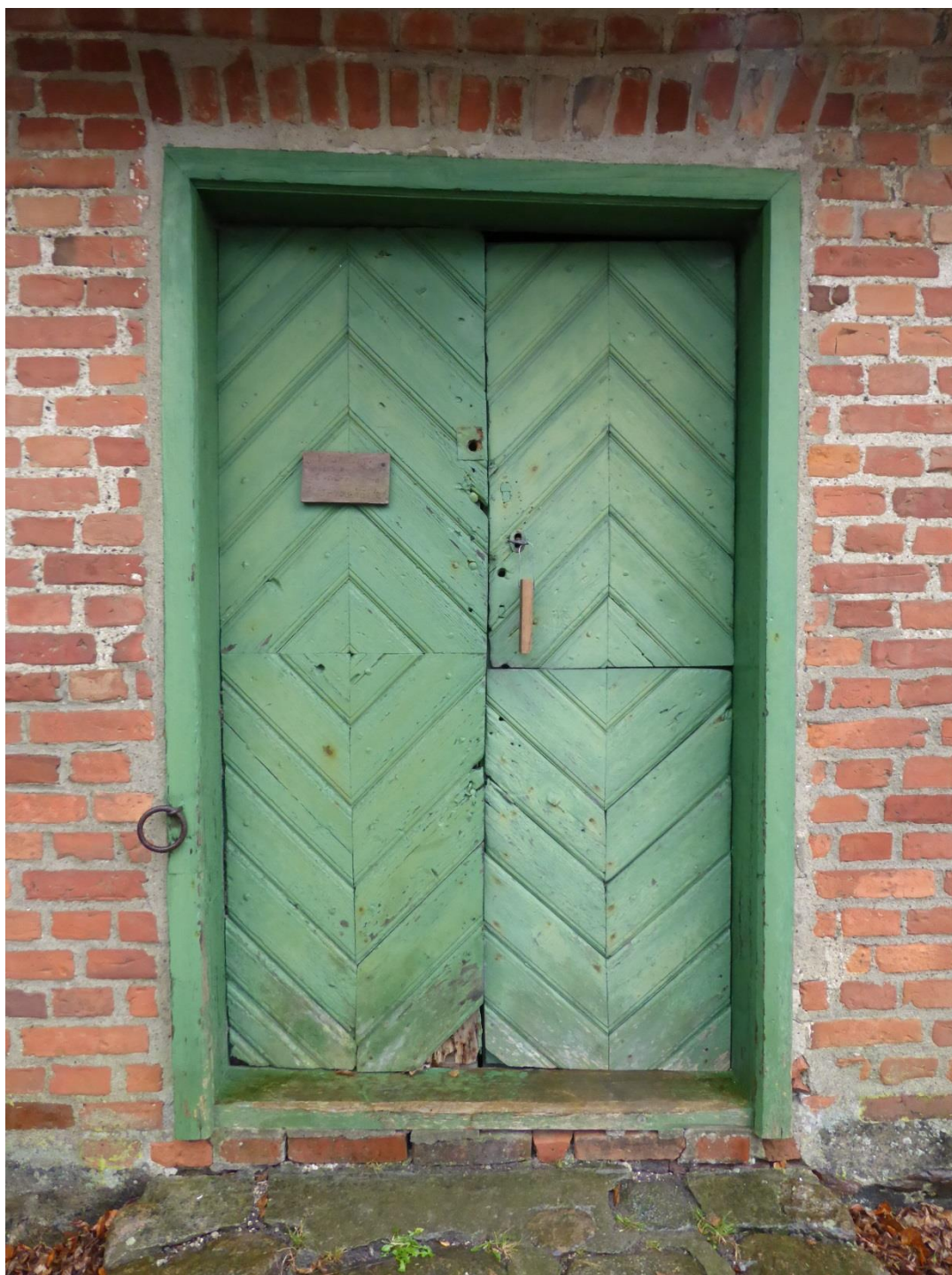
Entrédörr från utsida, inför åtgärd
