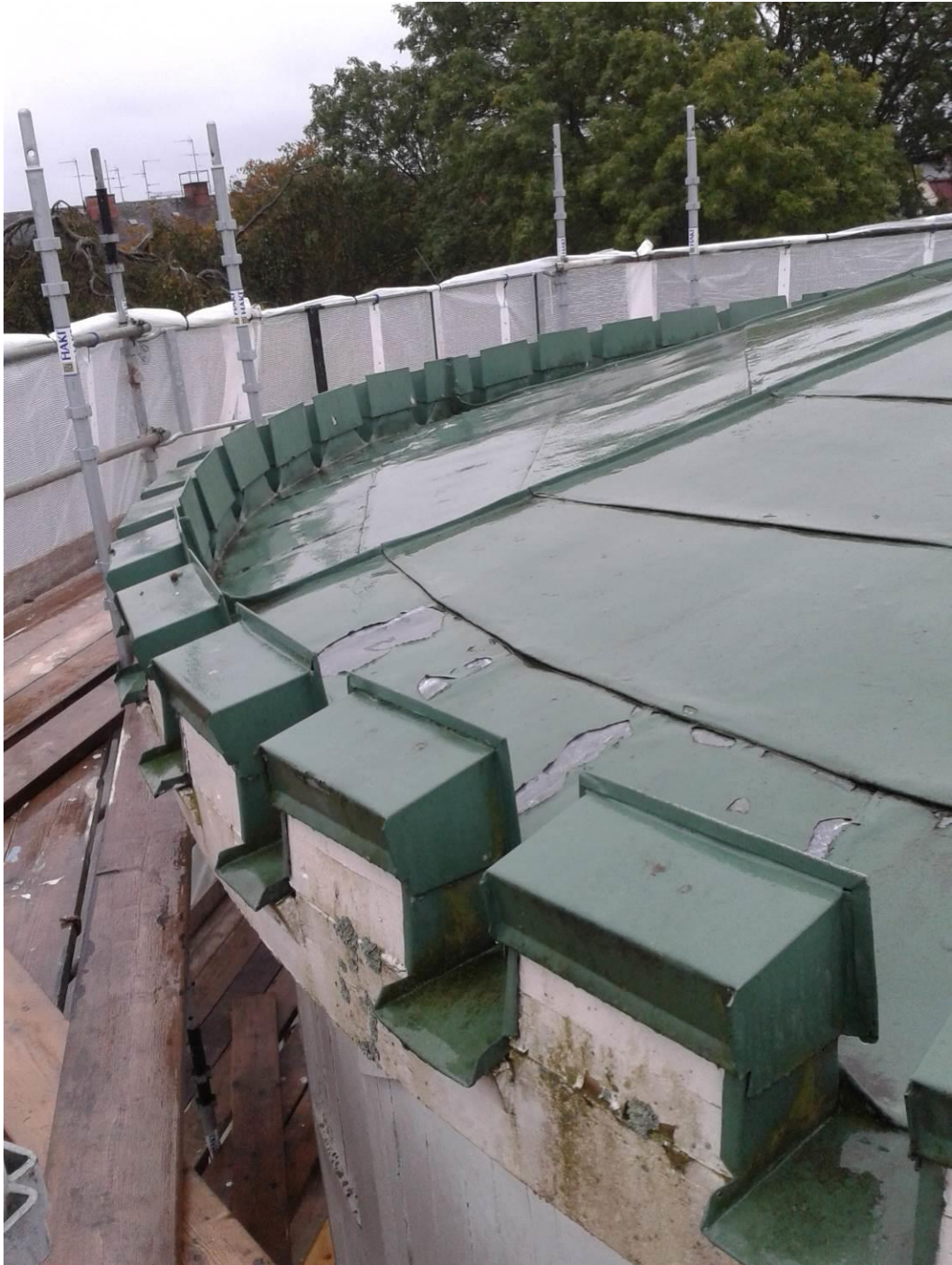
Figur 3. Före åtgärder. Del av tornets tak med färgsläpp och ytligt rötskadad tandsnittsfris.
