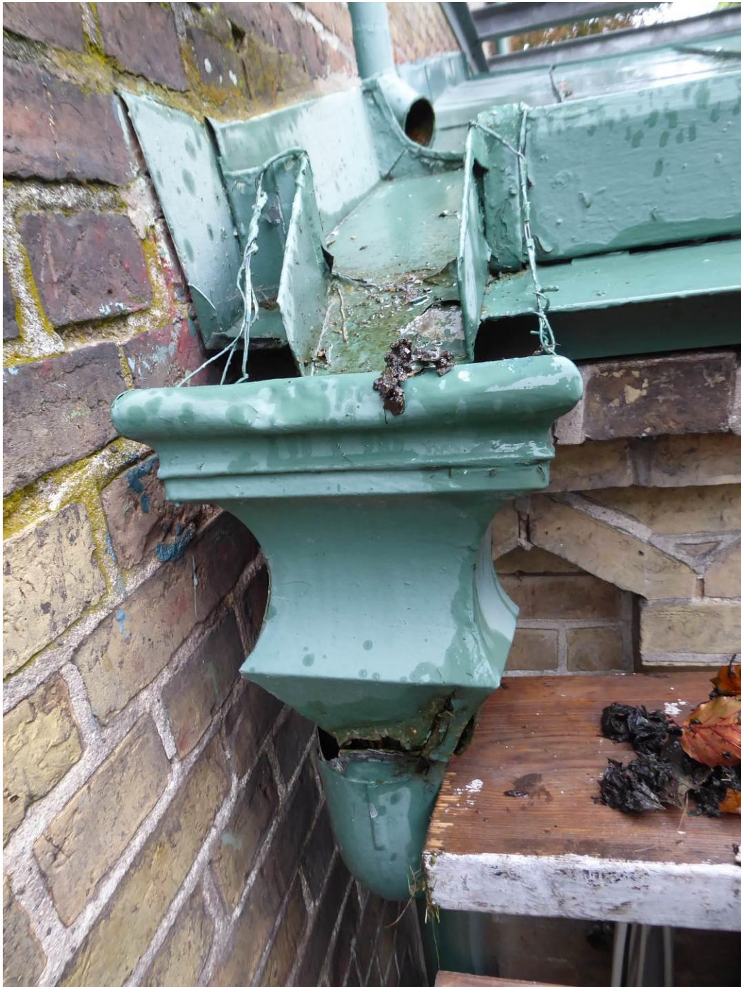
Figur 8. Före åtgärder. I sydvästra hörnet fanns en vattenkupa som möjligen var original men var tvungen att ersättas på grund av rostangrepp. Krönet har en rundad form i jämförelse med de övriga tidigare ersatta vattenkuporna som bockats med rakt krön.
