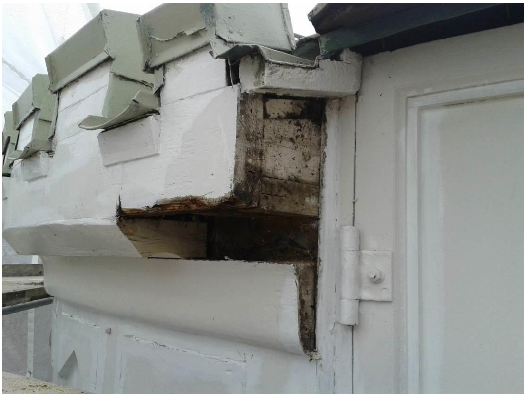
Figur 12. Under arbetet. Rötskadad del i trärisen på tornet är borttagen, invid spaltöppningen åt norr.
