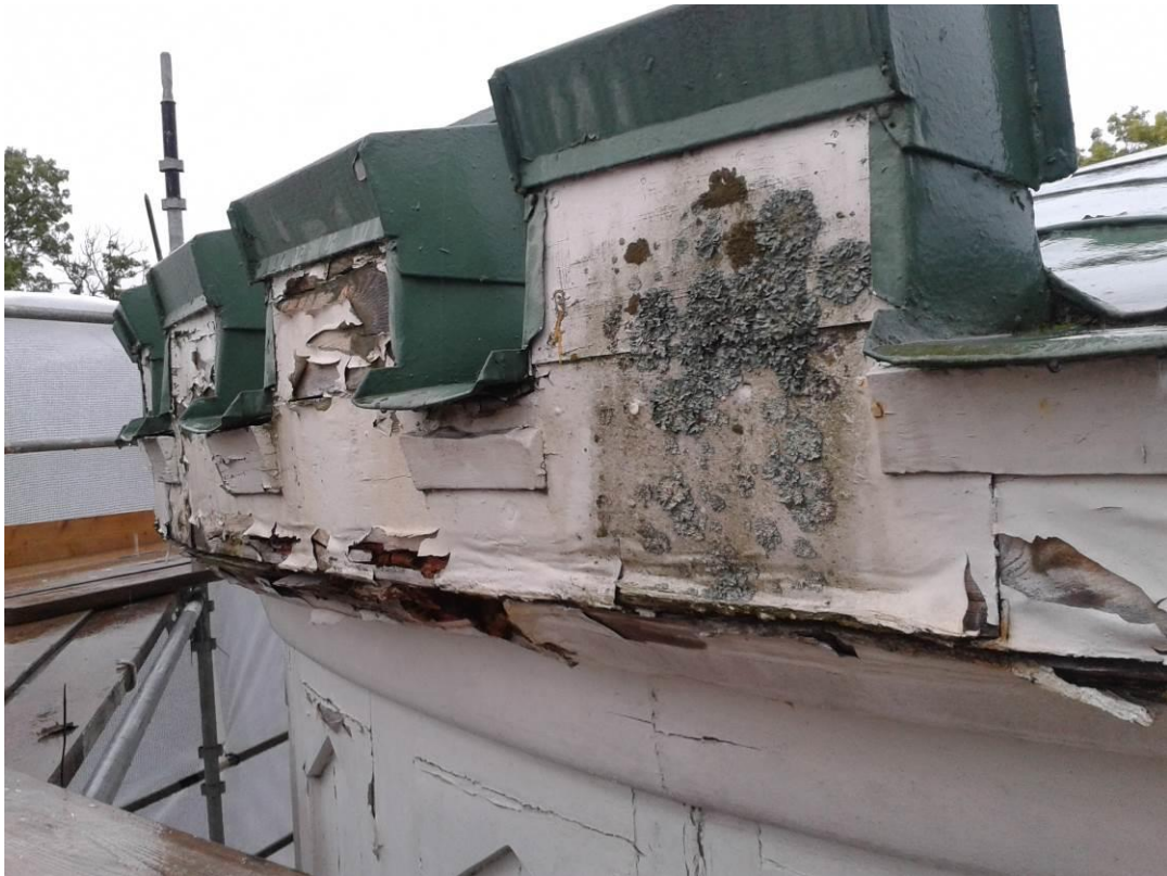
Figur 9. Före åtgärder. Skadade delar på tornet mot söder.
