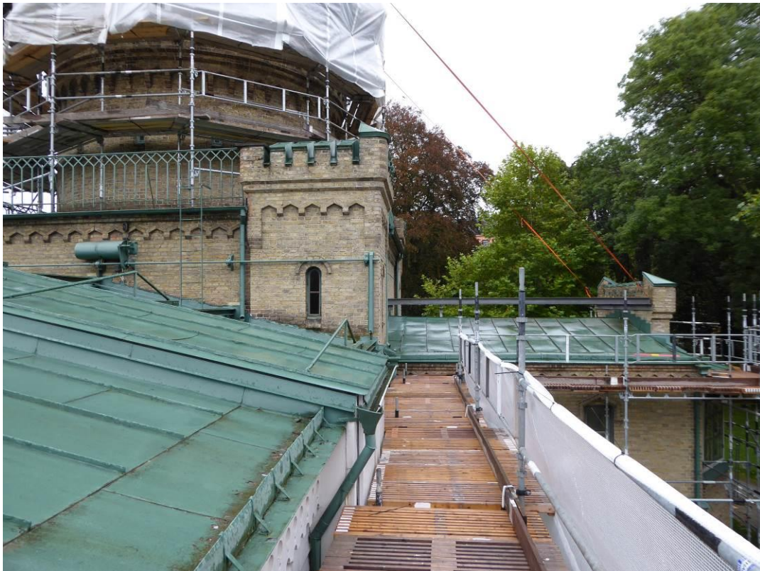
Figur 6. Före åtgärder. Till vänster i bild den västra flygeln med träfasad. Till höger i bild den södra flygeln där durkplåt monterats ner inför arbetena.
