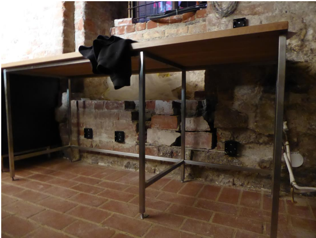
2016. Sentida färglager är varsamt borttaget på den södra väggen. Ny el har i huvudsak fästs i tegelfogen och döljs bakom inredningen.
