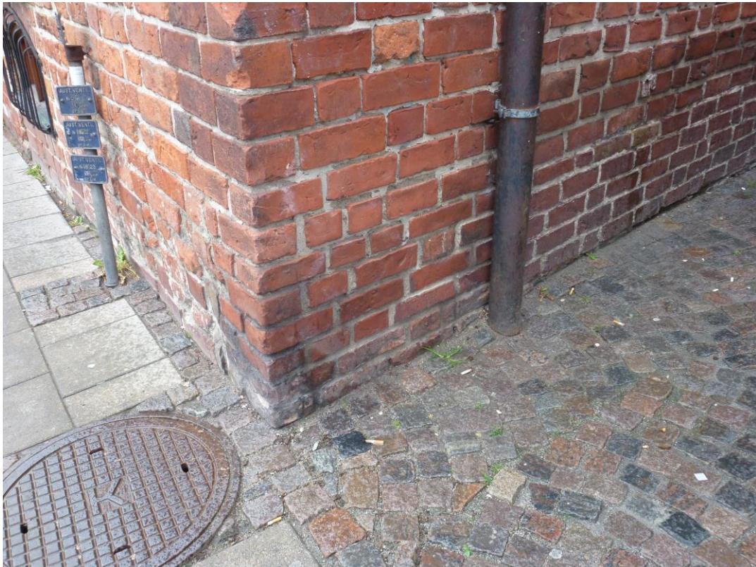
Figur 12. Före åtgärder. Vandalrör i nordöstra hörnet.
