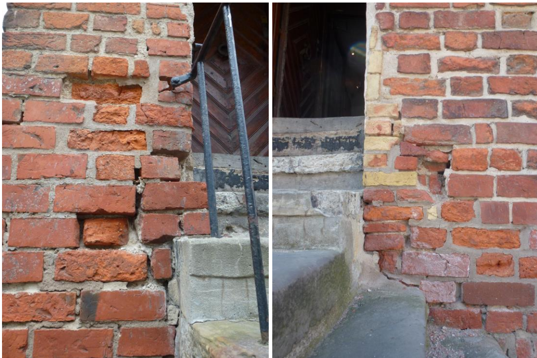
Figur 7 och 8. Före åtgärder. Vänster: Skadade tegelstenar och tegel murat på trappsteg. Höger: Tegelmur höger om dörren.
