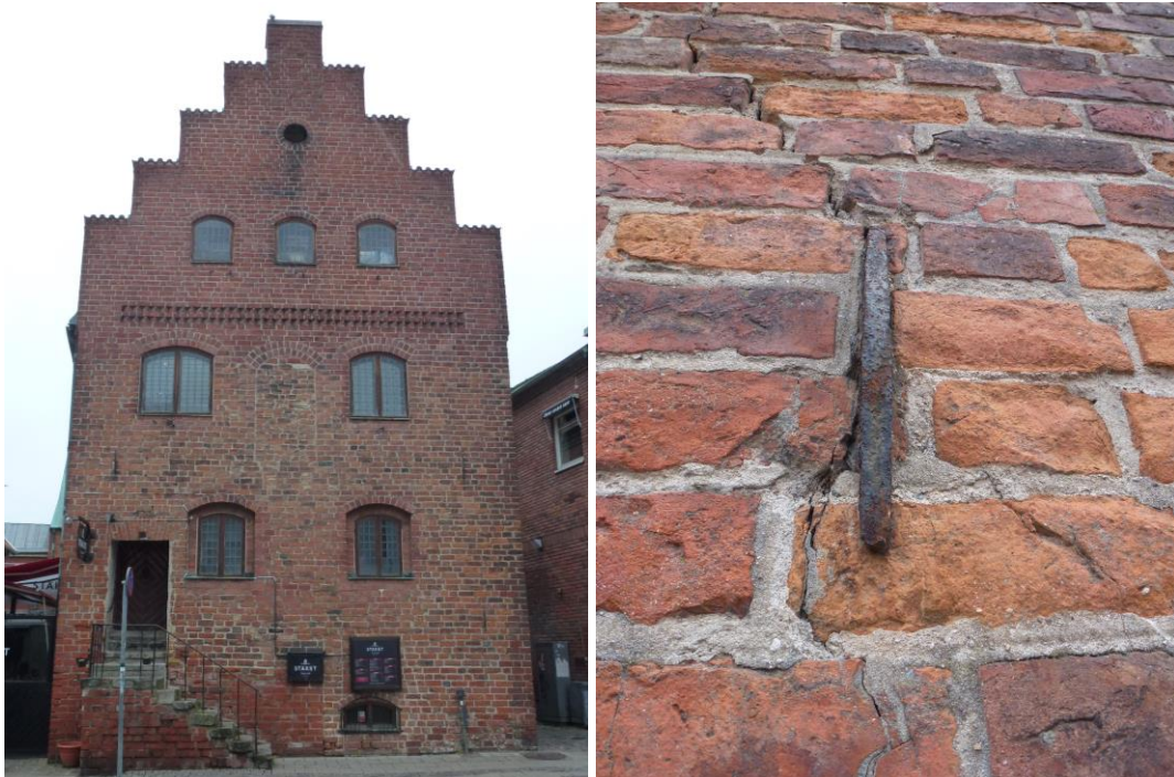
Figur 9 och 10. Före åtgärder. Östra fasaden och exempel på ankarjärn på östra fasaden.
