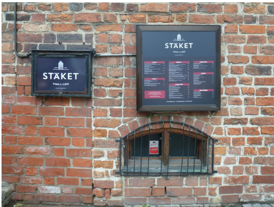
Figur 11. Före åtgärder. Skyltar och galler vid källarfönster. Skadad tegelfog i nedersta delen av fasaden.
