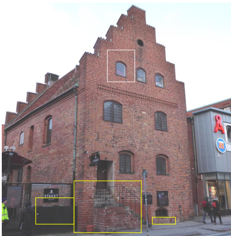
Figur 2. Ungefärlig omfattningen av omfogningarna markerad med gul linje. Ett fönster som försetts med ny blyspröjs markerat med vit linje. Fönstren på dessa två fasader samt dörren har underhållits.
