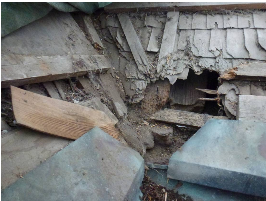
Figur 10. Vinkelränna under arbetet. Vinkelrännan i sydöst. Skadade stickespån samt något rötskadad taksparre. Taksparren förstärktes mot muren. Inga hammarband finns i denna del av byggnaden.
