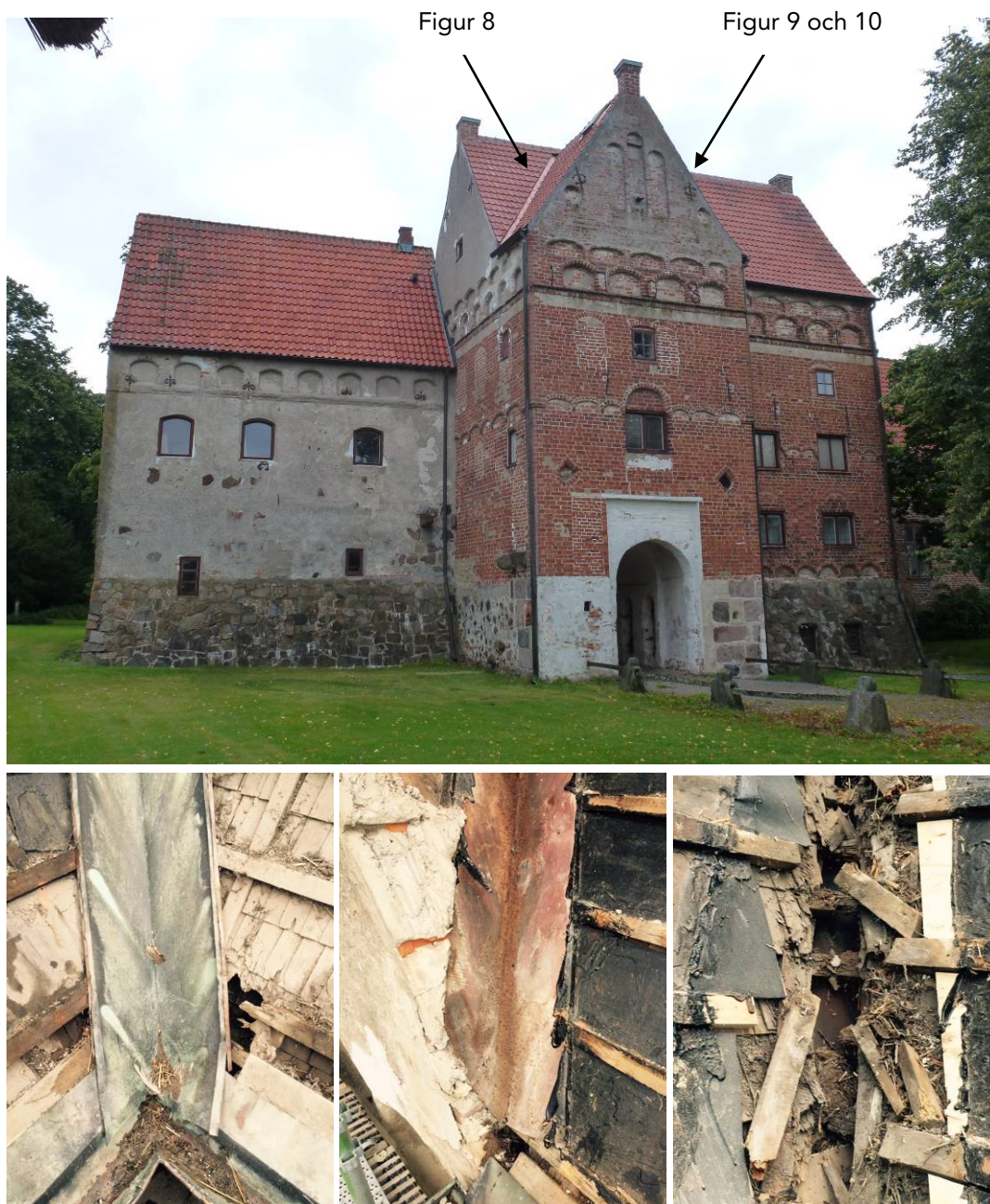
Figur 8. Vinkelrännan under arbetet. Bilder från vänster: Kopparplåten och sticketaket när takpannorna tagits ner. Under kopparplåten låg en galvaniserad rostad plåt. Under plåtarna var läkten och stickorna skadade och lappade vid tidigare tillfälle.
