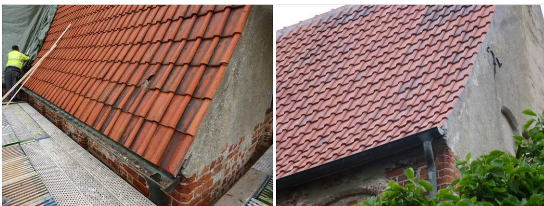
Figur 14. Vänster: före åtgärder. Takfall A hade en dåligt anpassad vinkling av nedersta takpannan mot hängrännan. Höger: efter åtgärder. Takfall A har försetts med takfotskil så att den nedersta takpannan vinklas något uppåt för bättre avrinning ner i hängrännan.
