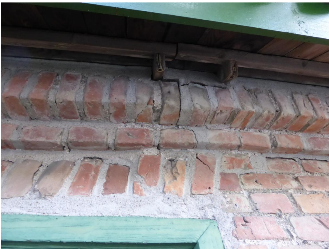
Sprickor i takfot norra sidan.
