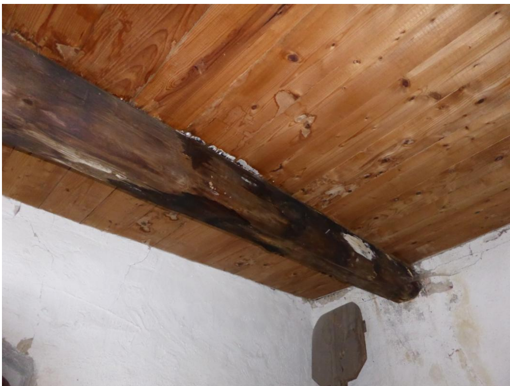
Takbjälke med rötskada
