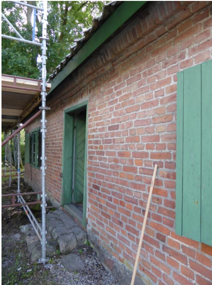
Takfot med sättningar, oklar anledning
