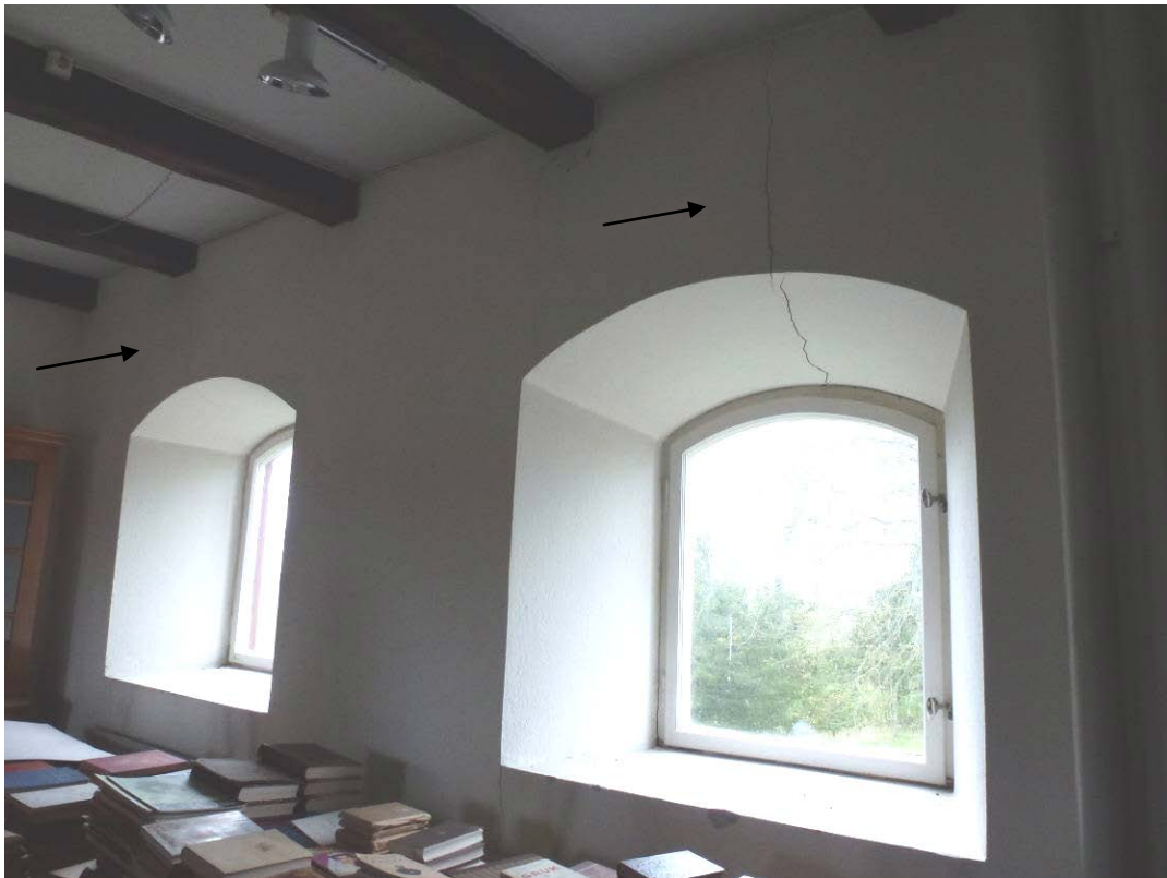
Före åtgärder. Sprickor ovan fönstren mot norr. Liknande sprickor finns även vid fönstren mot söder i samma rum.
