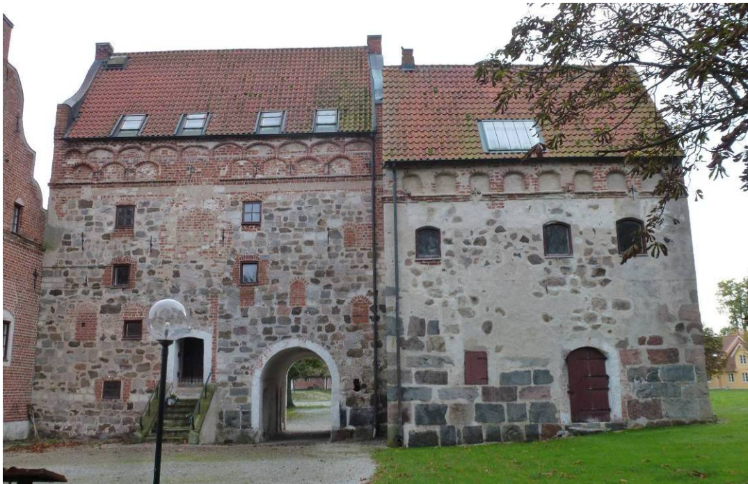
Figur 4. Efter åtgärder. Norra fasaderna. Något mer stenar har blivit synliga eftersom putsen satt helt lös på fasaden. I detta skede valdes att inte putsa över stenarna på nytt.
