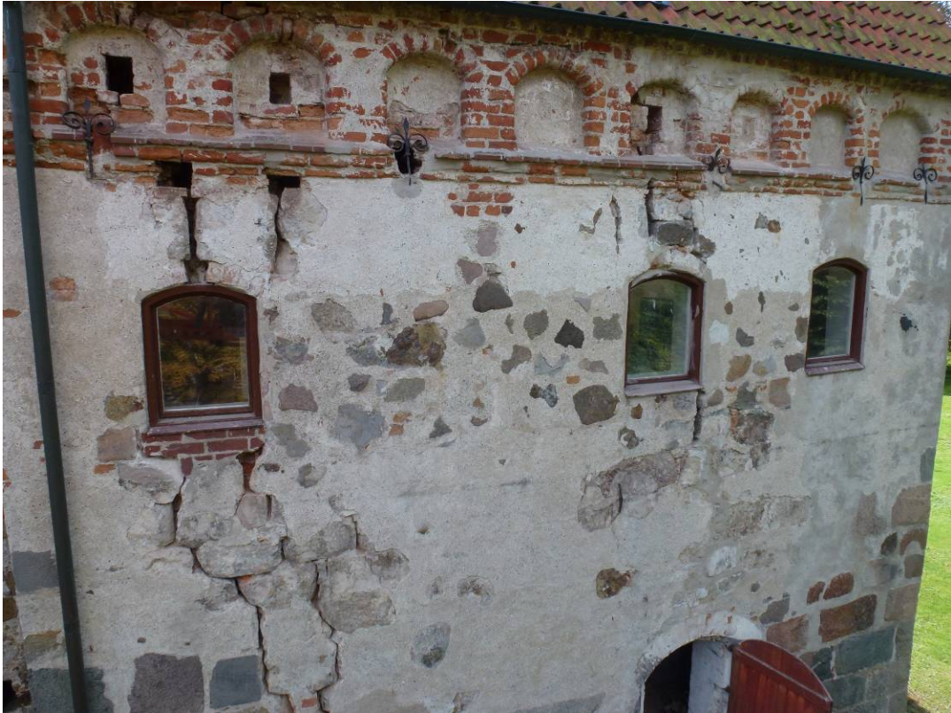
Sprickan till vänster i bild är rengjord inför lagning. Lagning av sprickan till höger i bild ovan dörren är påbörjad. I blindingarna ser man hålrummen som troligen härrör från när byggnaden uppfördes.
