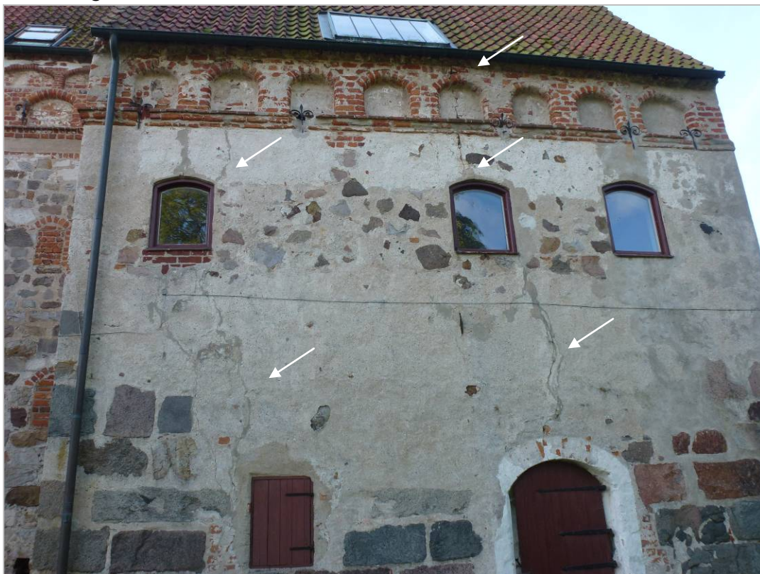
Figur 5. Före åtgärder. De stora sprickorna är markerade med pilar. Det horisontella "strecket" mitt på fasaden är en telefontråd som har tagits bort.
