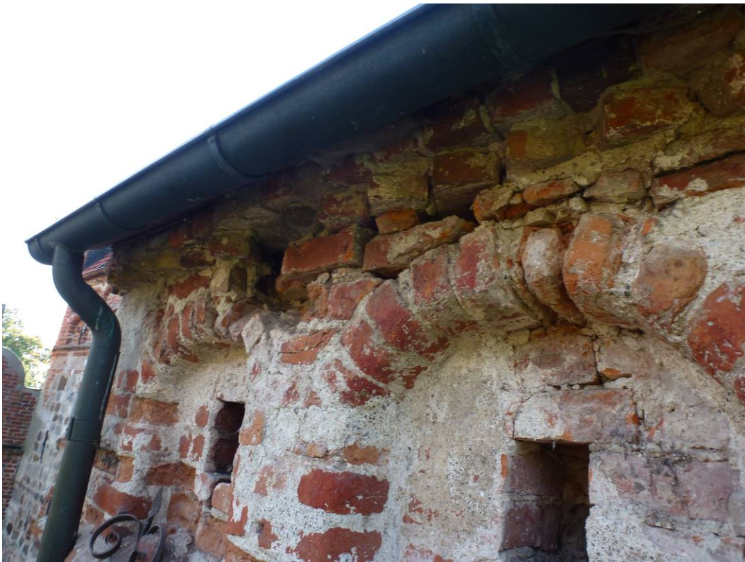
Skadad och vittrad takfot.
