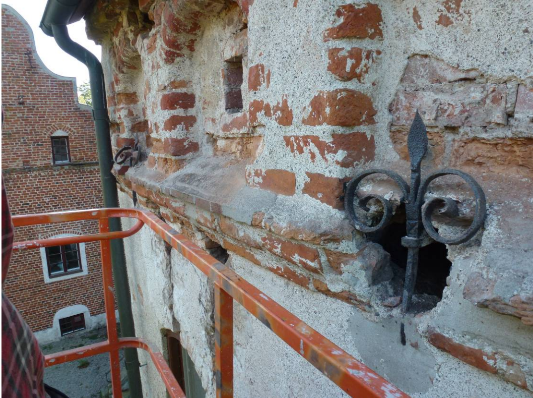
Exempel på skada vid dragjärn. Märk den dekorativa utsmyckningen av dragjärnet. De flesta dragjärn har denna form.
