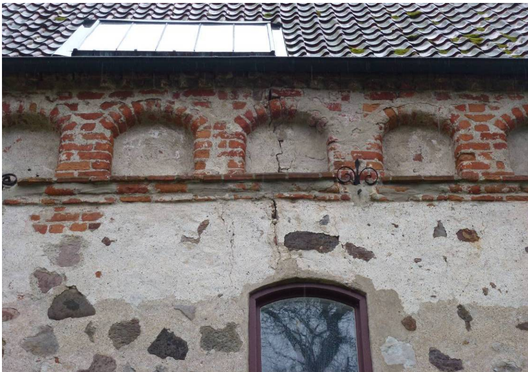
Före åtgärder. Sprickan som gick ända ner från takfoten till dörren på norra fasaden i kapellet.
