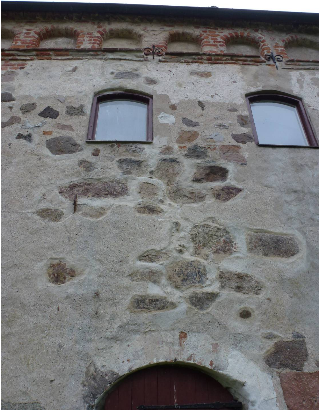
Efter åtgärder sprickan ovan dörren på den västra längan.
