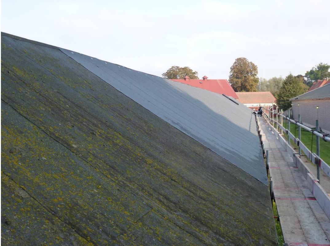
Figur 11. Under arbete. Östra takfallet. Gammal papp närmast och ny papp längre bort i bild.
