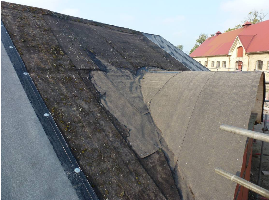
Figur 5. Under arbete. Homejan är uppbyggd på nytt och täckt med underlagspapp. Den nya pappan längst till vänster i bild och i mitten den gamla pappen lager på lager.
