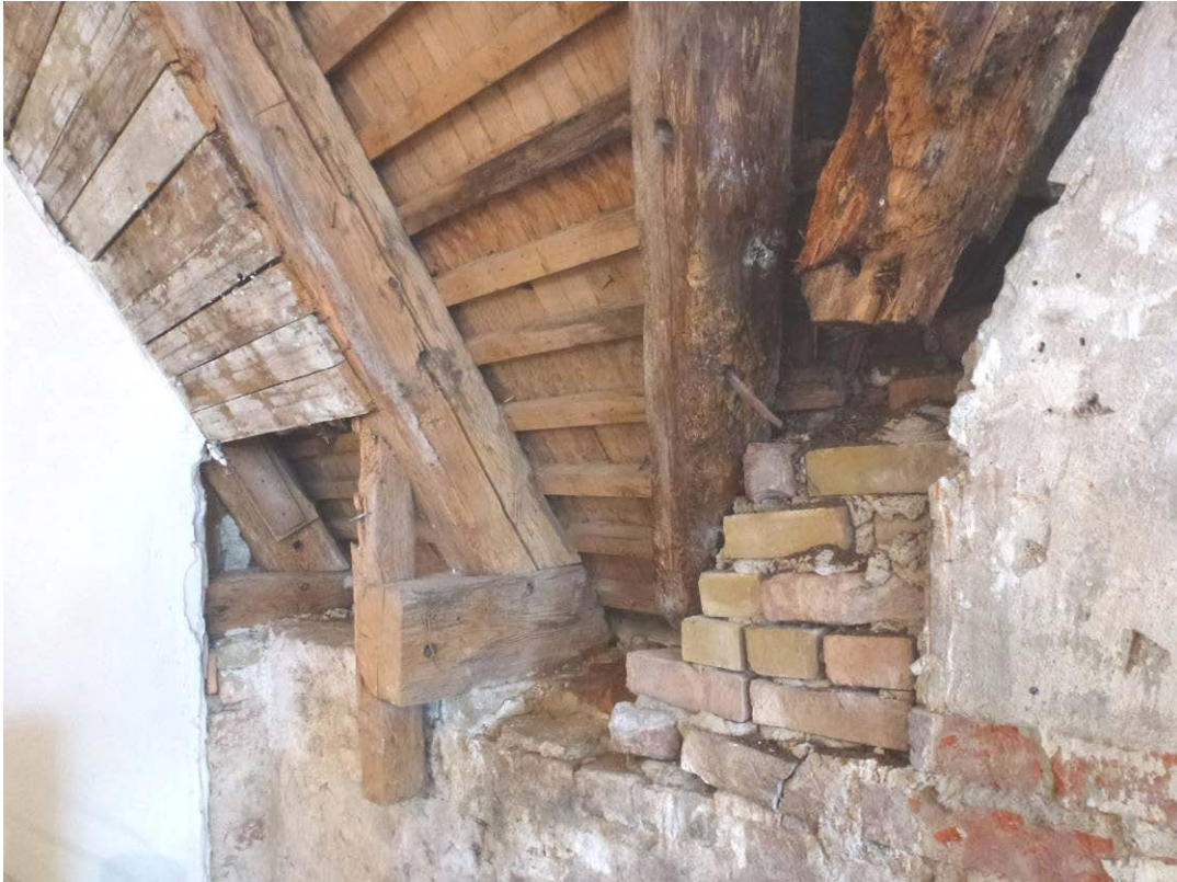
Före åtgärder. Två skadade takstolssparrar och den horisontella bjälken som redan tidigare var kapad.
