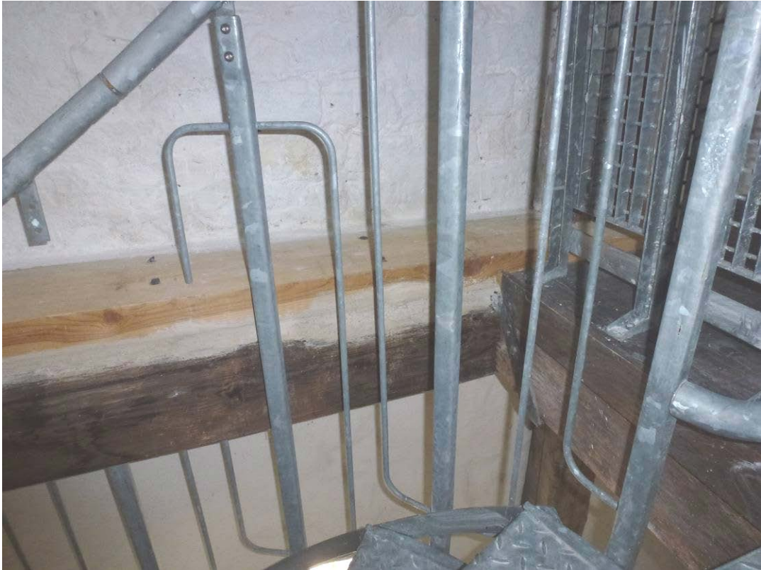
Efter åtgärder. Golvbjälken har förstärkts med en plank. Mellanrum mot befintlig bjälke har tätats med kalkbruk.
