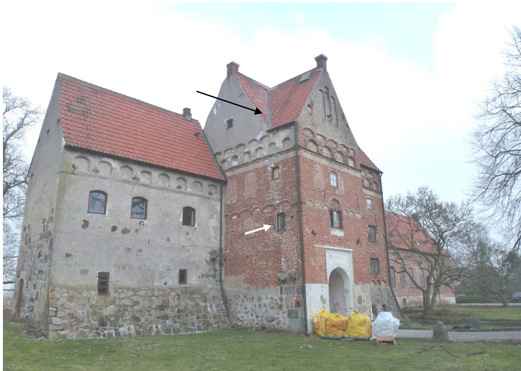
Porttornet med takskadorna i den sydvästra rännviden, markerad med svart pil. Vit pil markerar läget för badrummet med skador. Foto efter att yttertakets lagts.
