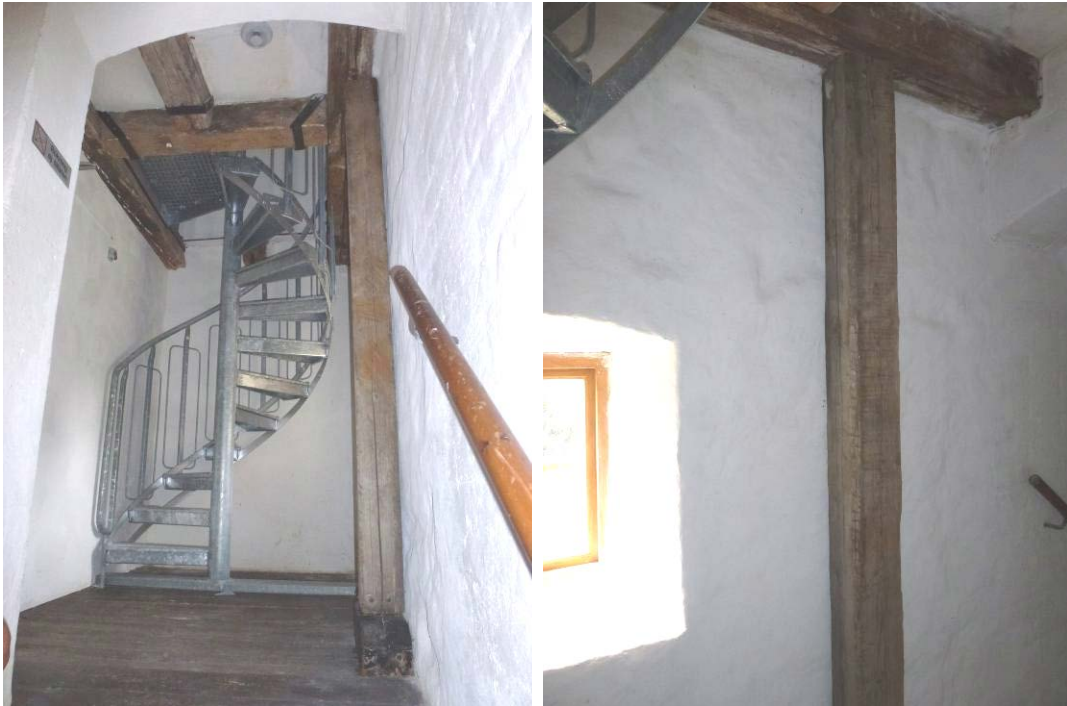
Efter åtgärder. Tegelväggen har avfärgats och en ny stödjande vertikal stolpe har monterats under den skadade golvbjälken och den nya stolpen som monterats in på 4:e våningen.
