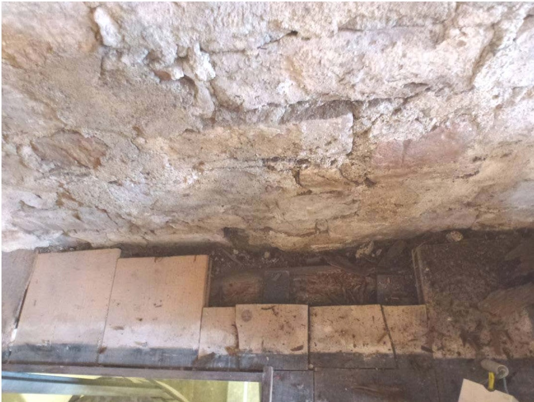
Före åtgärder. Den skadade golvbjälken. Tegelvägg med kalkputs är synlig i bilden.
