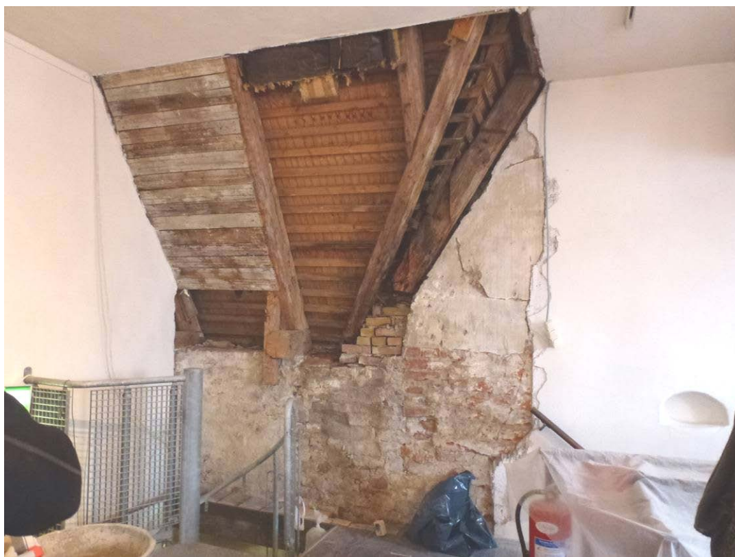
Före åtgärder. Innertaket har tagits ner och tegelvägg och takstol är synlig.
