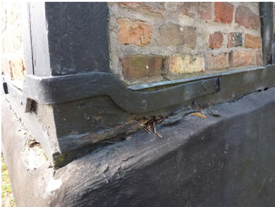
Före åtgärder: Sydöstra hörnet. Här kan man se att virket är sågat och att den rötskadade syllen ligger i en fåra på grunden.
