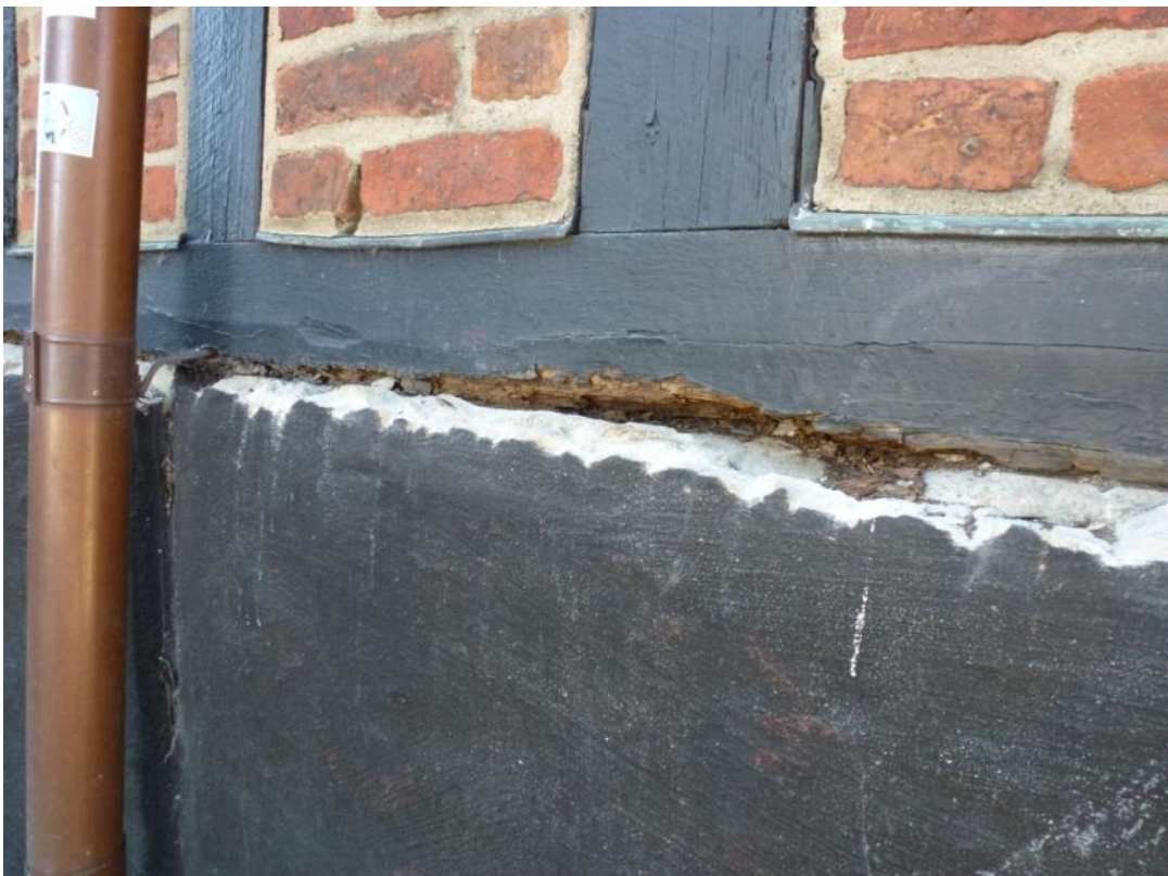
Under arbete. Södra fasaden. Runt hela huset är nedre delen av syllan rötskadad. Putsen knackades ner i förebyggande syfte och lagades med avfasad kant som inte täcker syllan.
