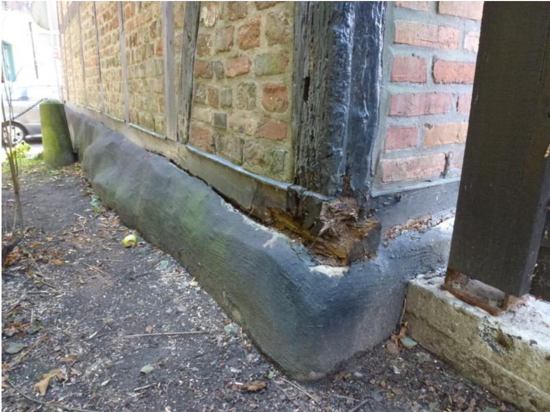
Före åtgärder. Nordöstra hörnet med kraftigt rötskadad syll och nedre del av stolpe. Stolpen är original och har en skåra mot norr där det före 1960-talet fanns en gårdsflygel.
