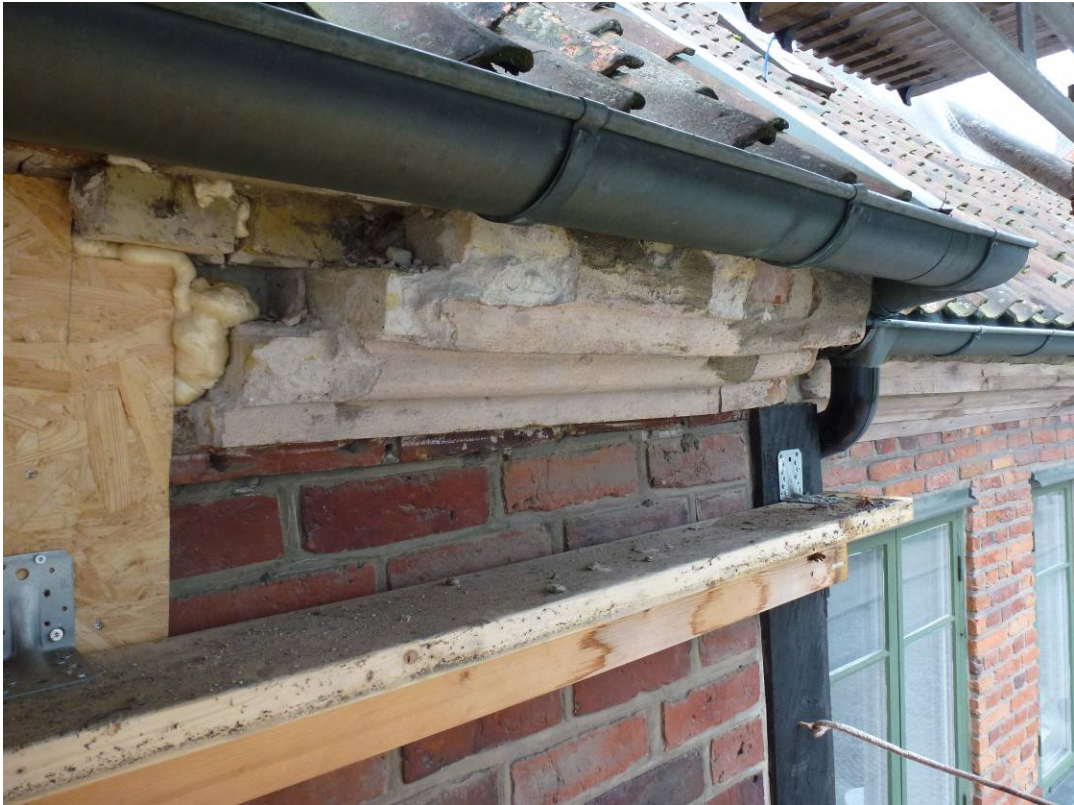
Den del av gesimsen som riskerade att falla ner har plockats ner 2012. Den västra delen av gesimsen som syns på bilden hade en enklare karnisprofil än resterande del på byggnaden.
