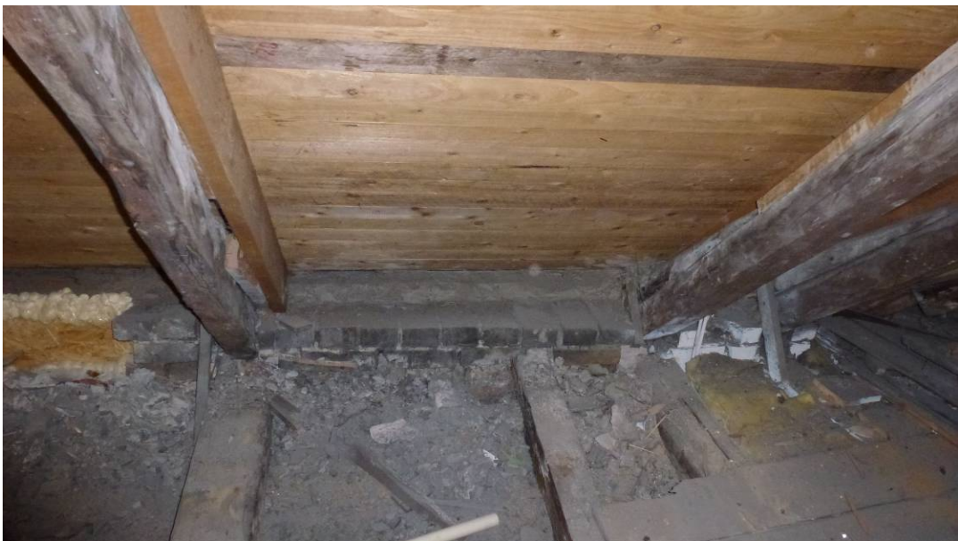
Före åtgärder. Här ser man de gamla takstolarna som tappade i golvbjälkarna. Under teglet i takfoten döljs lejden (till vänster i bild skivor som täcker hålrummet utifrån). Takstolarna är förstärkta på 1960/70-talet. Mellan golvbjälkarna har i något skede förstärkts med extra golvbjälkar.
