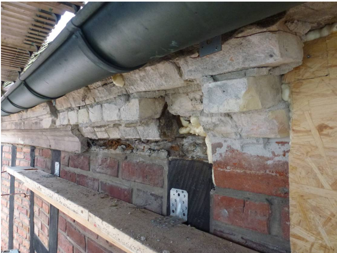
Före åtgärder. Foto mot öster. Den rikt profilerade gesimsen, gult tegel i gesimsen och den kraftigt rötskadade lejden och golvbjälke som dolts bakom gesimsen.
