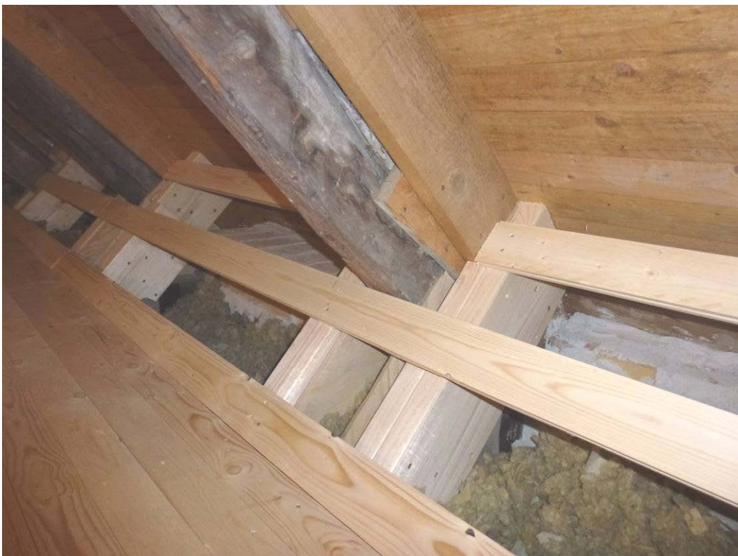
Efter åtgärder. Mot norr. Stödbenen mellan golvbjälkarna och takstolen. Ny stenullsisolering i bjälk-laget.
