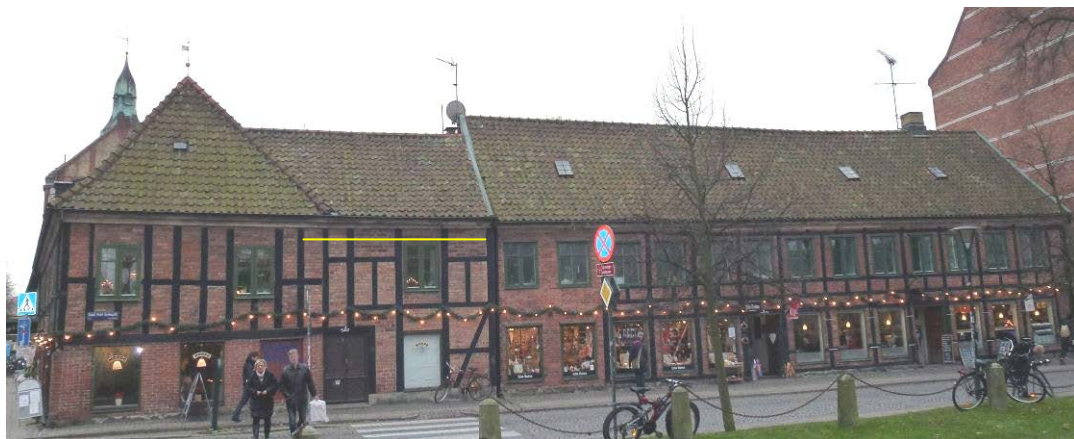
Byggnaden 2011 innan den skadade delen av gesimsen tagits ner. Aktuell del av gesimsen markerad med linje.
