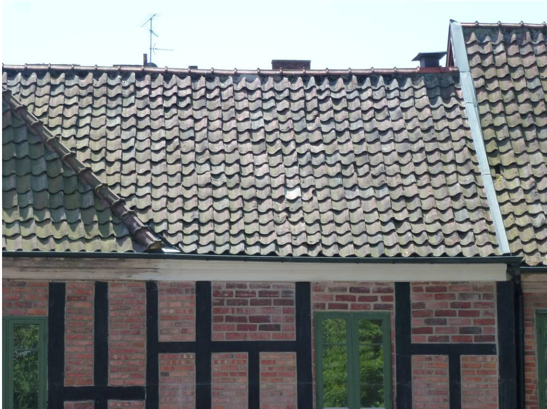
Efter åtgärder. Den gamla gesimsen möter lagningen i takvinkeln. Den skarvade stolpen är till höger om högra fönstret med ny täckbräda ungefär i höjd med löshulten. Nyuppmurat tegelfack ovan fönstret.
