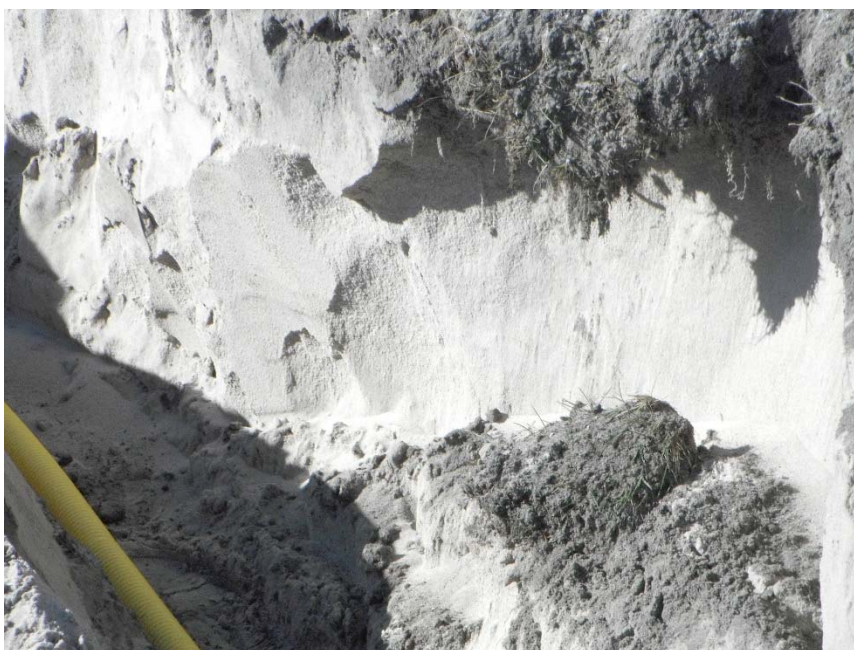
Figur 7. Kabelschaktet omfattade bara flygsand.
